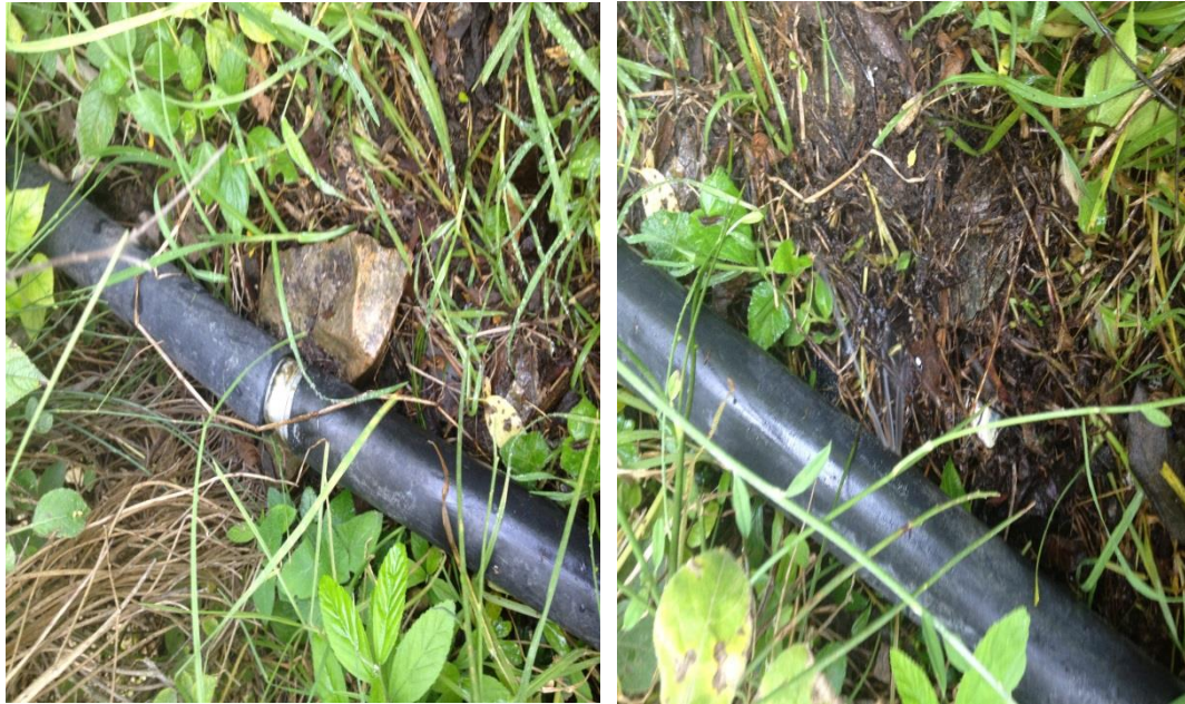
Red de distribución con uniones no adecuadas y con fugas de agua por rotura de las mangueras, además se puede ver que está a la intemperie de todos
