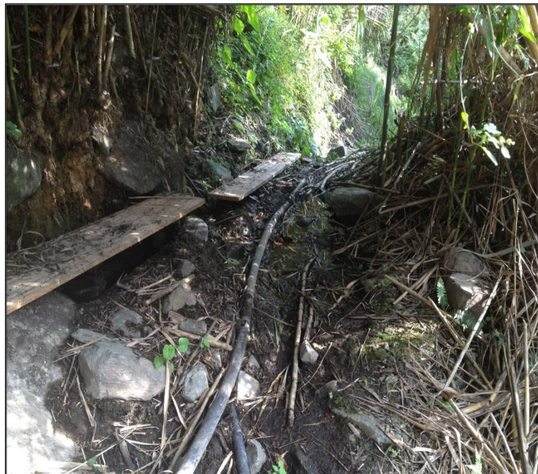
Red de conducción del líquido vital hacia el tanque de almacenamiento.
