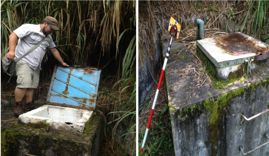
Tanque de captación de agua para abastecer del líquido vital a la parroquia Lligua Centro perteneciente al cantón Baños de Agua Santa.
