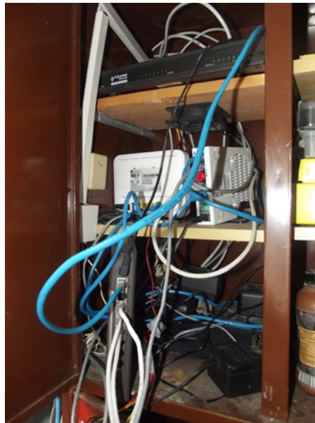
Figura 4.2: Armario de comunicaciones existente Elaborado por: El investigador
