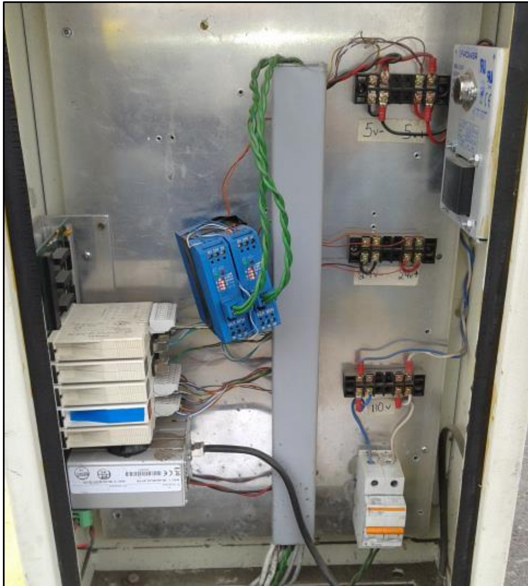
Figura 4.20 Armario de Control Calle Guayllabamba
