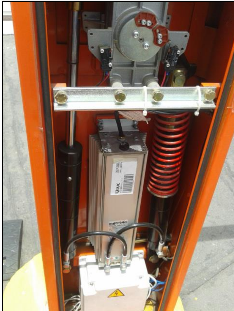
Figura 4.19 Sistema Hidráulico de Control de Barreras de Paso Elaborado por: El Investigador
