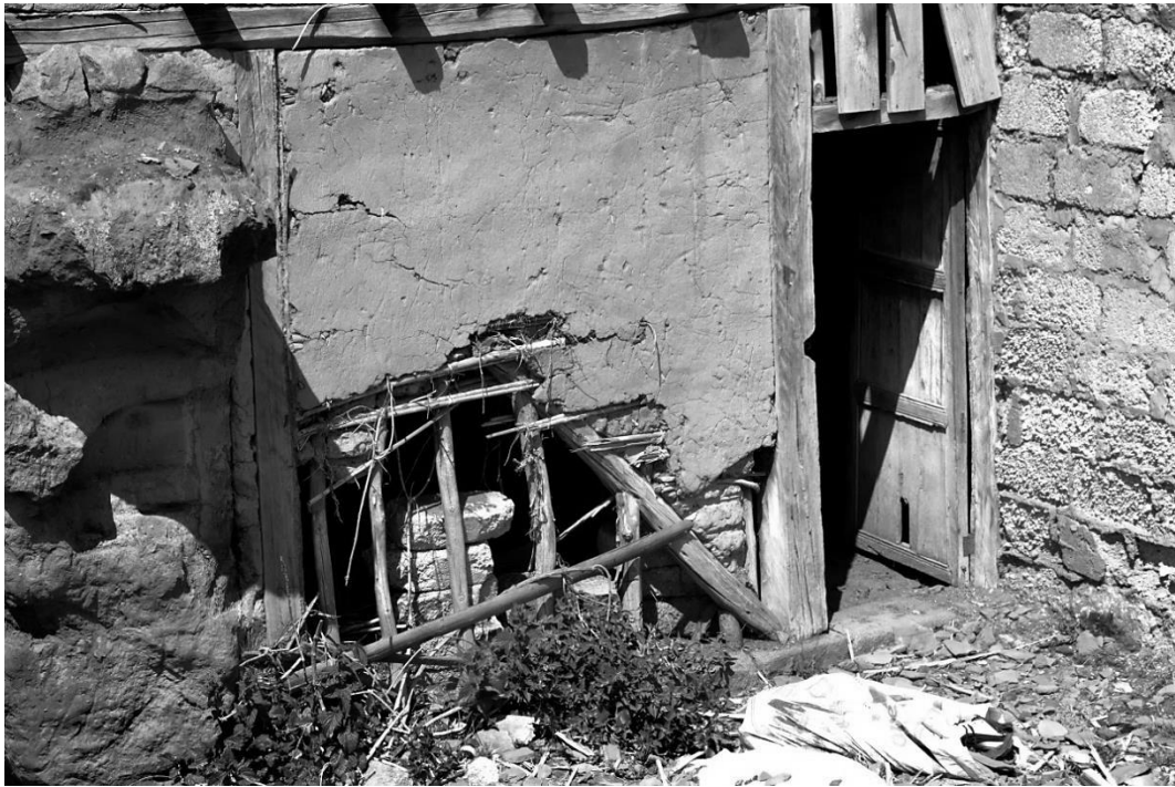
Fotografía 95: Deterioro de viviendas Autor: Bernardo Tuza
