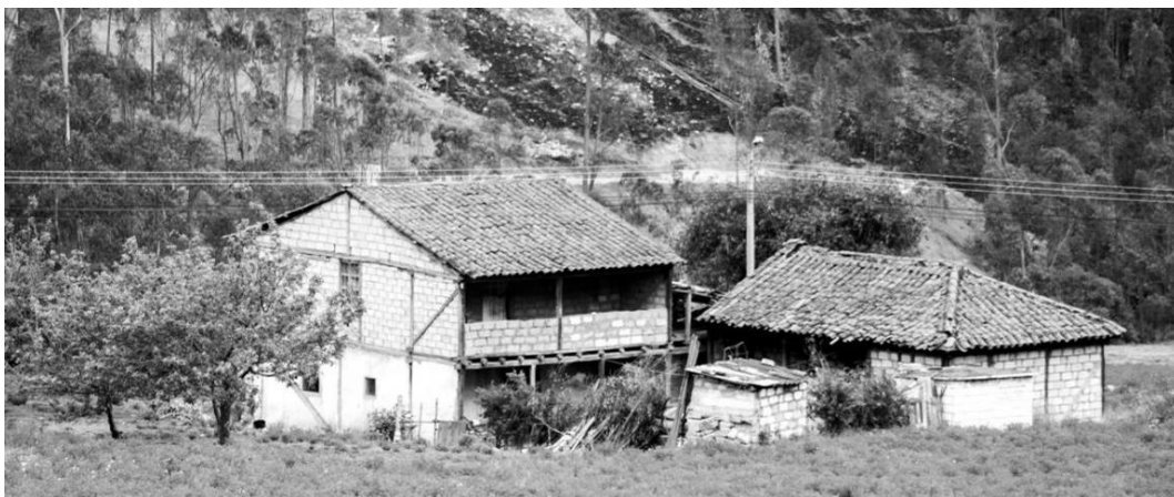
Fotografía 34: Deformación de edificación. Estructura de madera, paredes de bahareque y cubierta de teja. Autor: Jimmy Silva, Juan Flores. Retoque: Santiago Suárez Abril.
