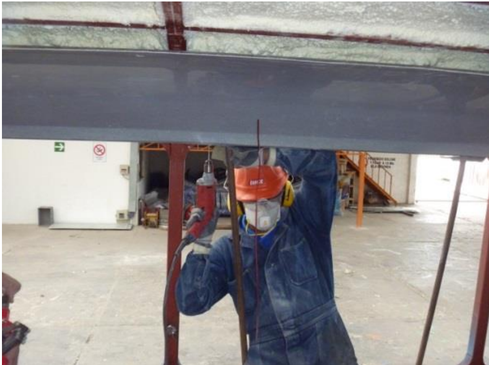
Figura 24. Procedimiento de Forrado Interior de techo (Fuente: Planta de producción IMCE, 2013, Modelo Interprovincial)
