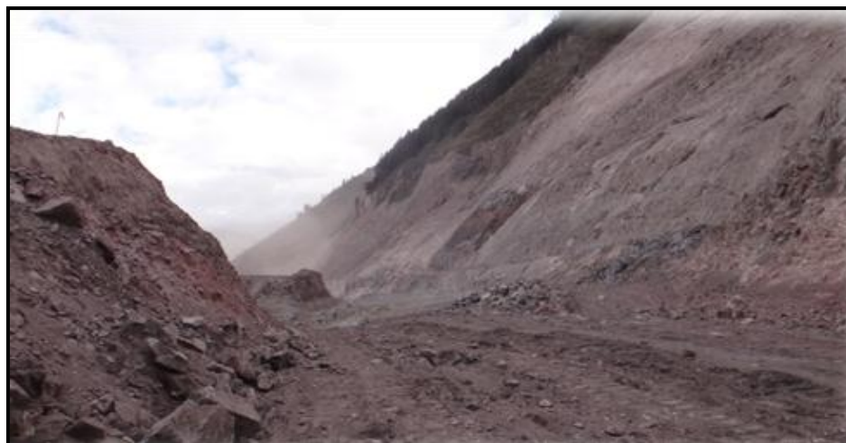
Foto 6.9.6 Sección transversal abscisa 5+500. Fuente: Libro de obra compañía Hidalgo & Hidalgo en la construcción de vía Cahuají-Pillate-Cotaló.
