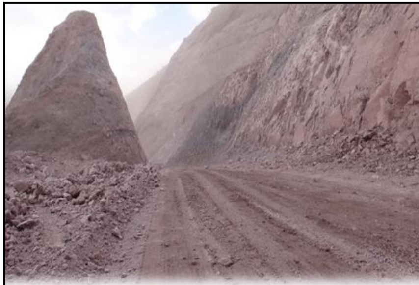
Foto 6.9.3 Sección transversal abscisa 3+000 perfil real. Fuente: Libro de obra compañía Hidalgo & Hidalgo en la construcción de vía Cahuají-Pillate-Cotaló.
