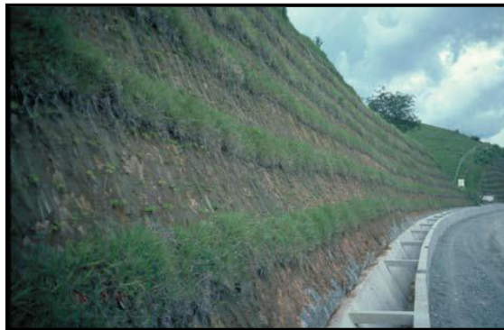
Foto 6.2 El drenaje superficial evita que las aguas de escorrentía se infiltren en el talud y reducen efectos erosivos. Fuente: Google, Drenaje superficial.
