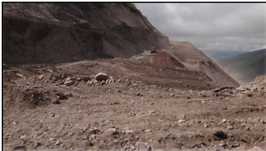
Foto 6.9.7 Sección transversal abscisa 6+000 perfil real. Fuente: Libro de obra compañía Hidalgo & Hidalgo en la construcción de vía Cahujá-Pillate-Cotaló.
