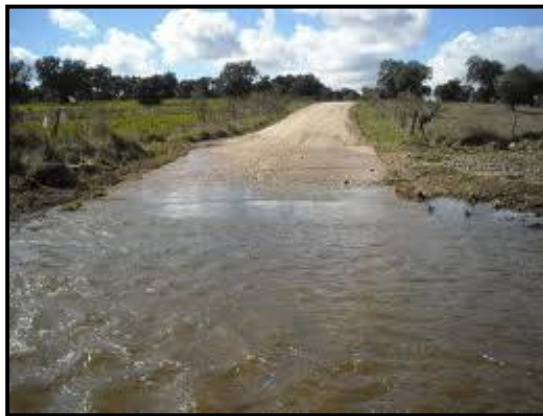
Foto 2.2 Ubicación inadecuada de un camino, el cual se ha convertido en “riachuelo” y está hidrológicamente “conectado” a los arroyos que lo circundan. Fuente: Google, riachuelos en caminos.
