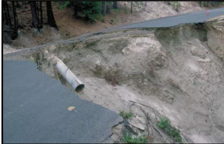
Foto 5.1 Falla de relleno de un camino en terreno escarpado, para el que ahora se requiere una estructura de contención o un corte alto para retener o ampliar el camino alrededor de la falla.
