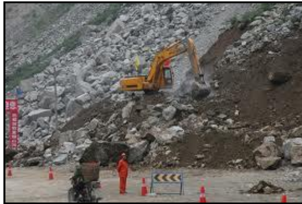
Foto 3.3 Una correcta señalización y ubicación de un sitio de trabajo evita inconvenientes en la construcción. Fuente: Google, señalización en caminos.
