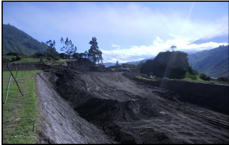
Foto 6.10.1 Adaptación de la topografía con el lugar, una de las soluciones que presenta la guía en el proceso de excavación. Fuente: Libro de obra en construcción de la vía Cahuají-Pillate-Cotaló.
