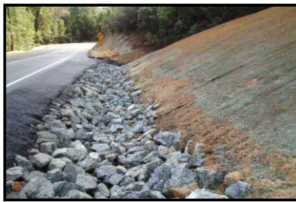
Foto 4.3 Cuneta a un lado del camino, revestida con rocas bien graduadas para el control de la erosión.
