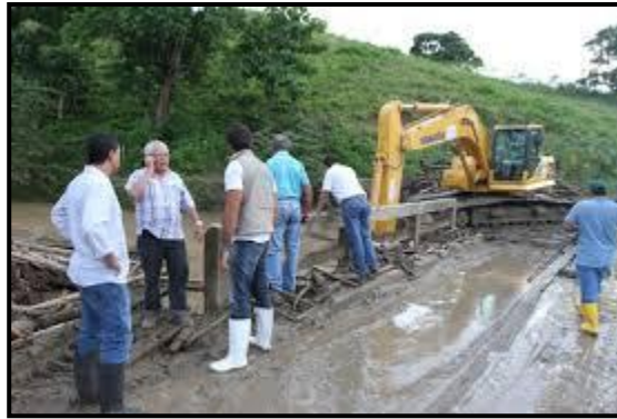
Foto 2.1 Un mal estudio hidrológico conlleva a una inundación, poniendo en riesgo el proyecto vial como a la comunidad beneficiada. Fuente: Google, inundaciones.
