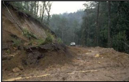
Foto 2.1 Camino problemático debido a fallas en los cortes del camino. Los problemas de inestabilidad ocasionan retrasos en los usuarios del camino y altos costos de mantenimiento o de reparación. Fuente: Google, derrumbes en caminos.
