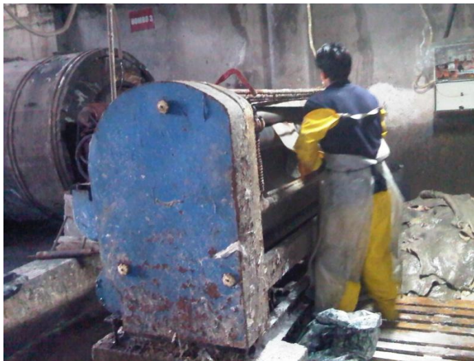
Gráfico N. 35: Zona Húmeda falta de mantenimiento y señalética
