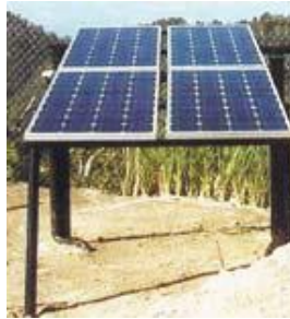
Gráfico No. 22 Paneles fotovoltaicos y su estructura metálica soporte.
