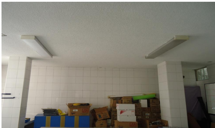
Gráfico No. 19 Cuarto de Equipos Realizado por: Aracelly Núñez
