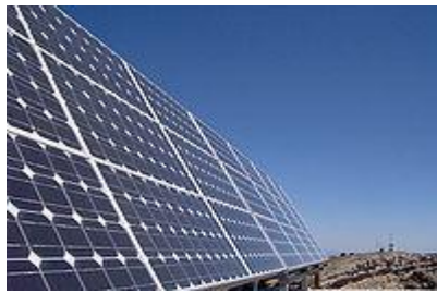
Gráfico No. 3 Paneles solares
