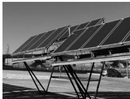
Figura 4. Paneles Solares Instalados en el Garaje de un Hotel [20]
