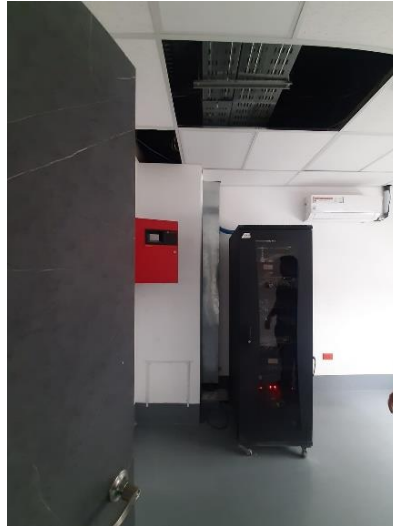
Figura 15. Instalaciones del Data Center
