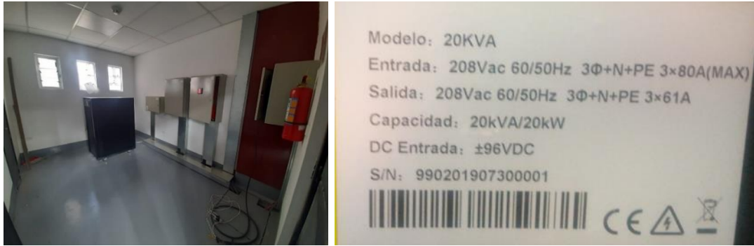
Figura 11. Instalaciones de la UPS
