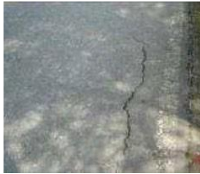
Fig. N° 10 GRIETA DE BORDE
