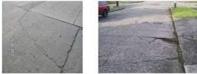
Fig. N° 27 DESCASCARAMIENTO DE ESQUINA
