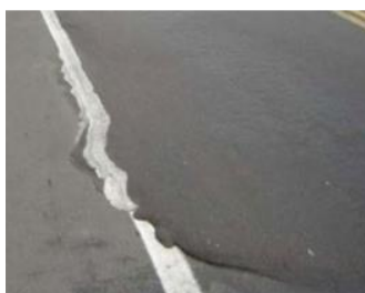
Fig. N° 7 ABULTAMIENTO Y HUNDIMIENTO
