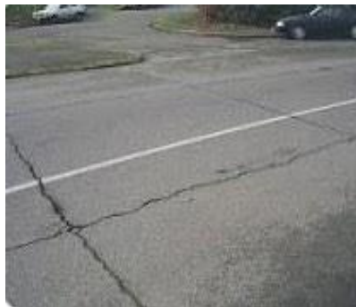
Fig. N° 13 GRIETAS LONGITUDINALES Y TRASVERSALES
