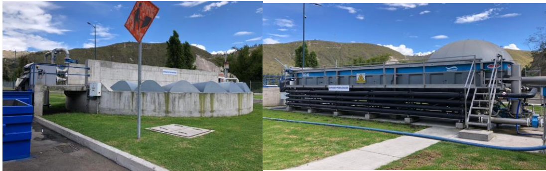
Figura 34: Espesador por gravedad y equipo de flotación de fangos.
