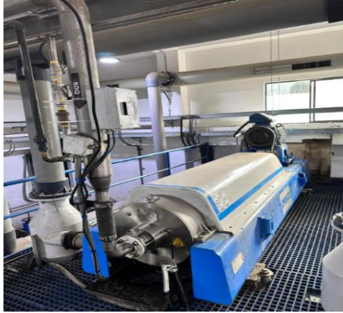
Figura 38: Deshidratación de fangos mediante centrifuga
