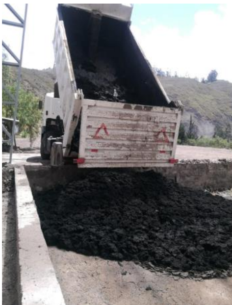
Figura 40. Lecho de secado de lodos
