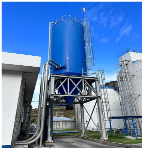
Figura 39: Silo de almacenamiento de fangos deshidratados
