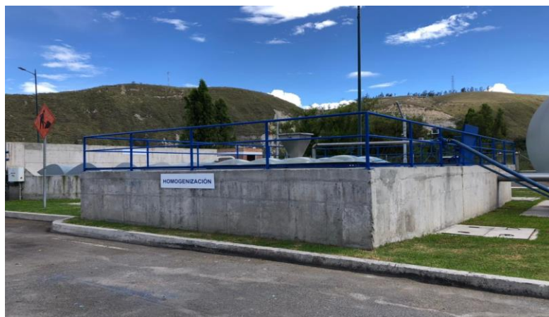
Figura 35: Tanque de homogenización de lodos
