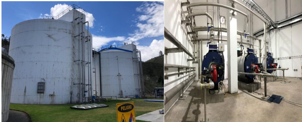
Figura 36: Digestores anaerobios y calefacción de lodos
