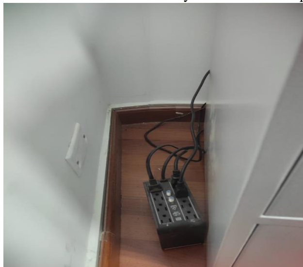
Figura 27. Conexiones eléctricas y de red área de captaciones
