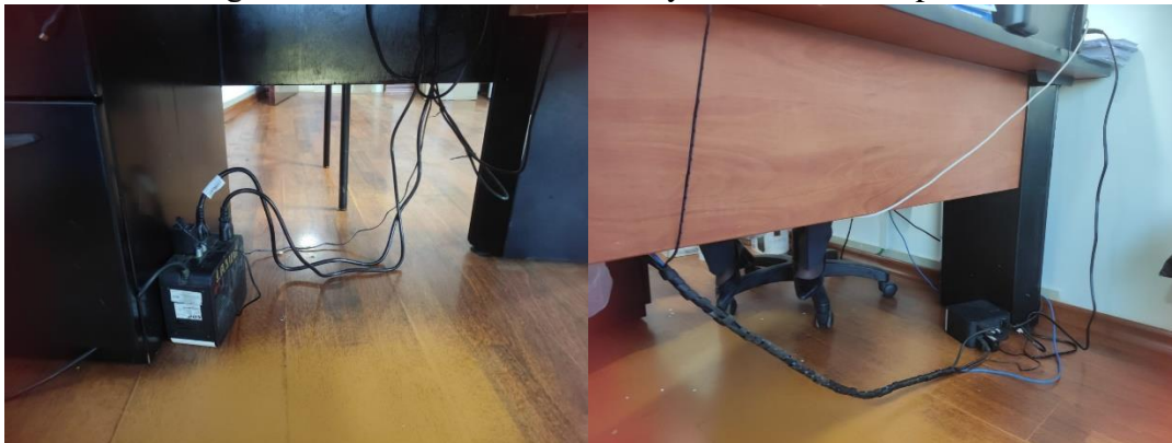
Figura 31. Conexiones eléctricas y de red área de operaciones
