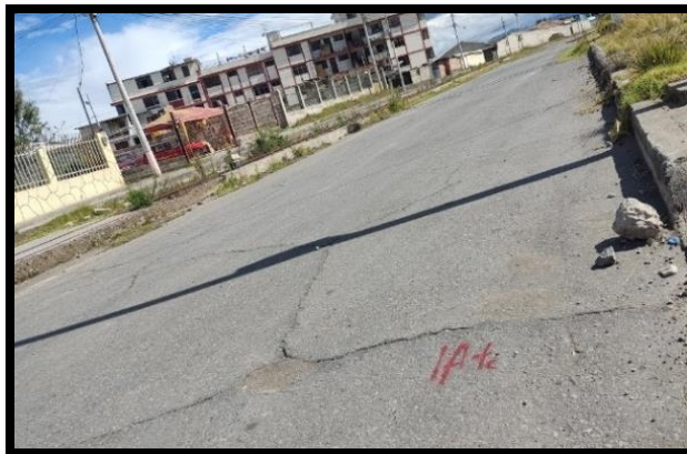
Figura 5. Agrietamiento en bloque.
