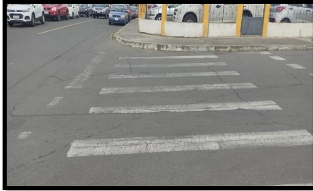
Figura 10. Grieta de reflexión de junta.
