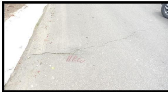
Figura 12. Grietas longitudinales y transversal.
