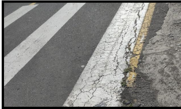
Figura 9. Grieta de borde
