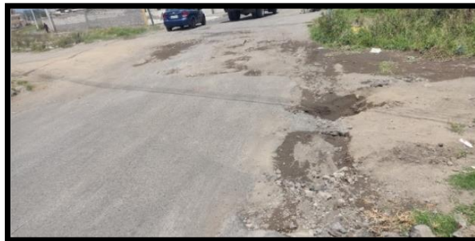
Figura 11. Desnivel carril / berma.
