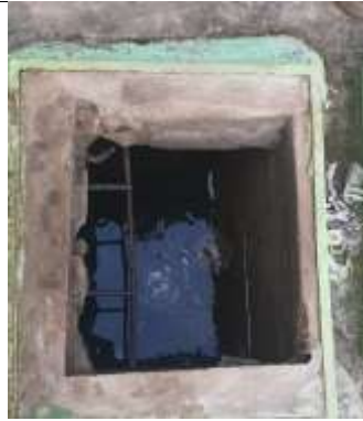
Deterioro en los materiales de la caja de revisión en la vertiente.
