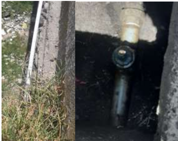
Imagen 12: Deterioro de componentes de la red
