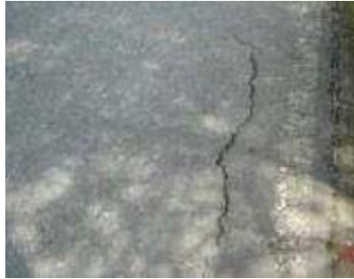
Fig. N.º- 10 GRIETA DE BORDE
