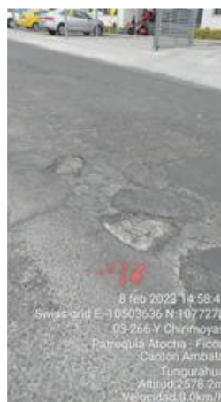
Fig. N.º- 58 DESPRENDIMIENTO DE AGREGADOS ZONA 4
