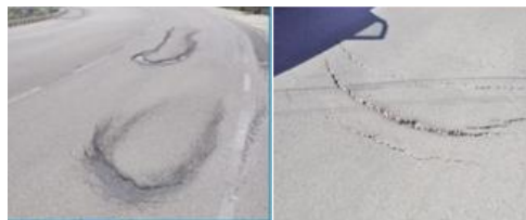
Fig. N.º- 21 GRIETA PARABÓLICA
