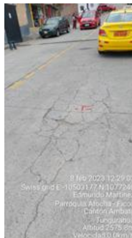
Fig. N.º- 74 FISURAMIENTO ZONA 4
