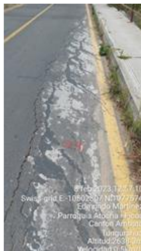
Fig. N.º- 54 GRIETA PARABÓLICA ZONA 4
