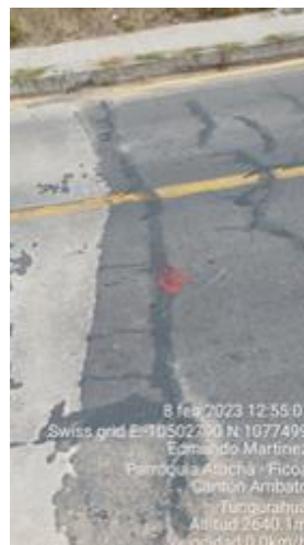
Fig. N.º- 4448 GRIETA DE REFLEXIÓN DE JUNTA ZONA
