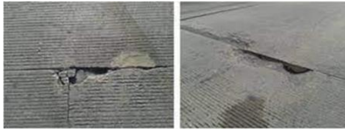
Fig. N.º- 28 DESCASCARAMIENTO DE JUNTA
