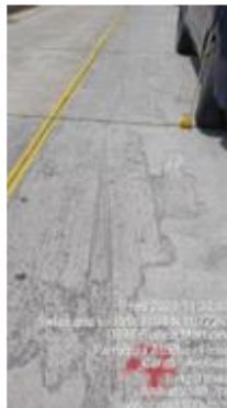
Fig. N.º.- 70 DESCASCARAMIENTO ZONA 4
