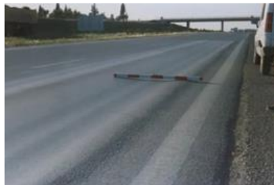
Fig. N.º.- 19 AHUELLAMIENTO
