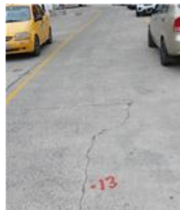
Fig. N.º- 76 AGRIETAMIENTO LONGITUDINAL ZONA 4
