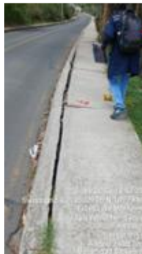
Fig. N.º- 68 ESCALONAMIENTO DE JUNTA ZONA 4
