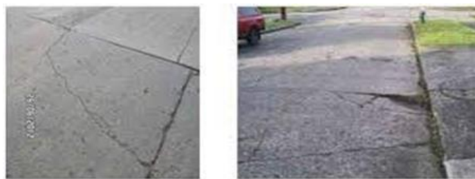
Fig. N.º- 27 DESCASCARAMIENTO DE ESQUINA
