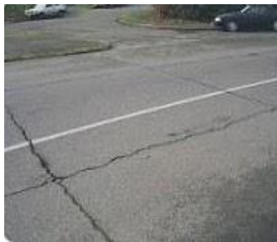
Fig. N.º- 13 GRIETAS LONGITUDINALES Y TRASVERSALES
