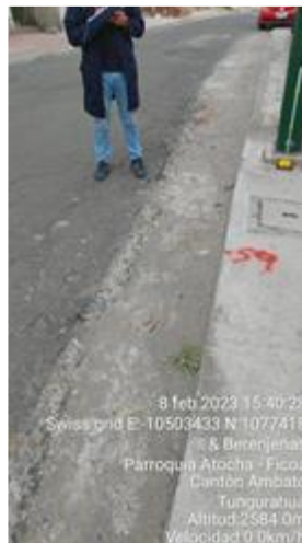
Fig. N.º.- 6065 ELEMENTOS FALTANTES
