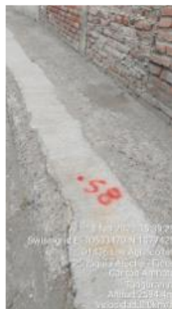
Fig. N.º.- 72 DESGASTE SUPERFICIAL ZONA 4
