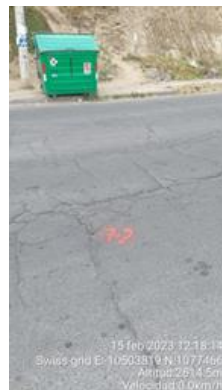
Fig. N.º - 386 AGRIETAMIENTO EN BLOQUE ZONA
