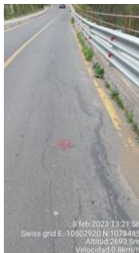
Fig. N.º.- 42 GRIETA DE BORDE ZONA 4
