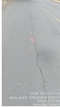
Fig. N.º - 46 GRIETAS LONGITUDINALES Y TRASVERSALES ZONA 4
