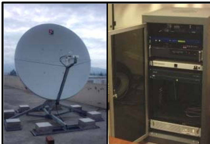
Figura 4.13. Unidades de la estación VSAT ubicadas en el predio Huachi.
