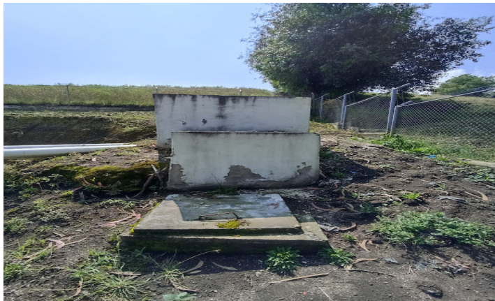
Figura 19.- Tanque repartidor de la PTAR comunidad Pilco.
