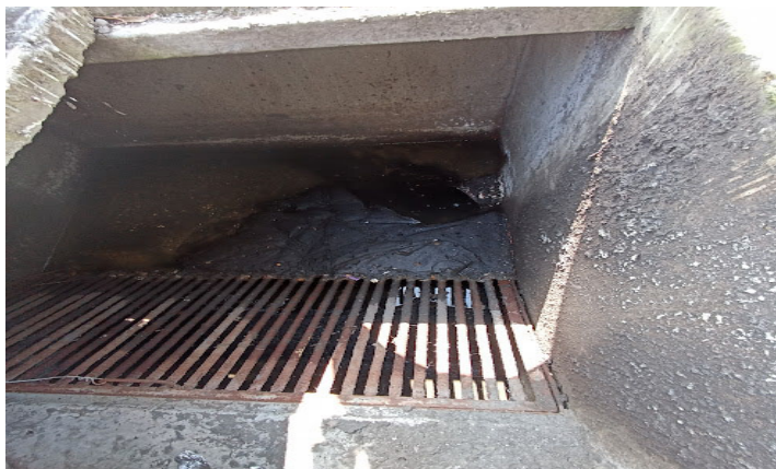
Figura 20.- Interior tanque repartidor de la PTAR comunidad Pilco.
