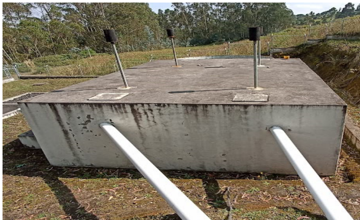
Figura 21.- Tanque séptico de la PTAR comunidad Pilco.
