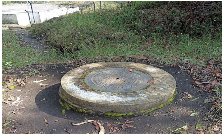
Figura 5.- Pozo de entrada para realizar muestreo y aforo, PTAR Comunidad Pilco, Parroquia Rumipamba.
