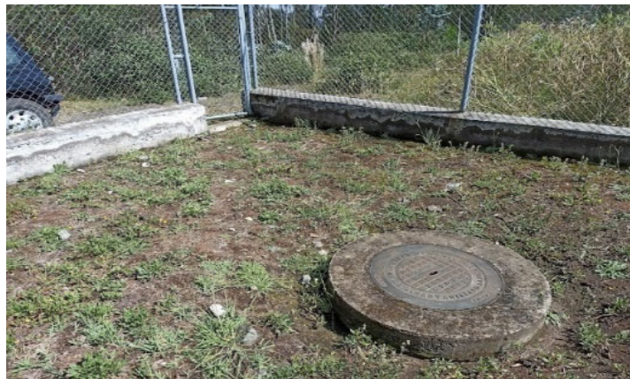
Figura 6.- Pozo de salida para realizar muestreo y aforo, PTAR Comunidad Pilco, Parroquia Rumipamba.
