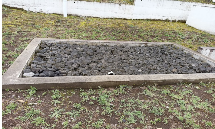
Figura 26. Filtro anaerobio flujo descendente PTAR comunidad Pilco.
