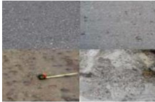
Figura 8 Falta de adherencia
