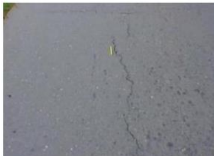
Figura 7 Fisuras y grietas longitudinales
