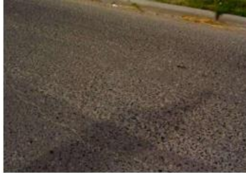
Figura 6 Desprendimiento de Partículas
