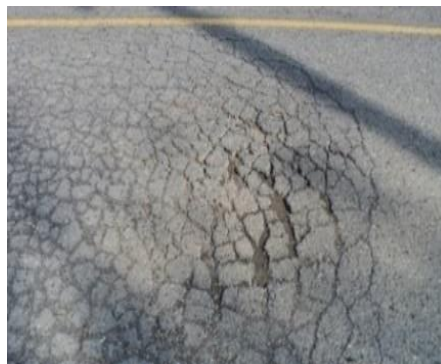
Figura 5 Falla piel de cocodrilo
