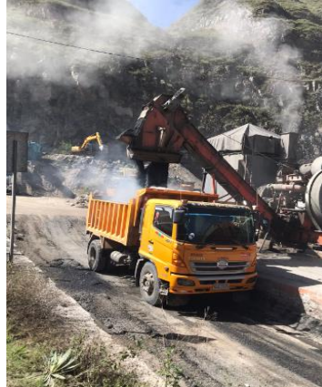
Figura 10 Planta de asfalto JEAL Construcciones
