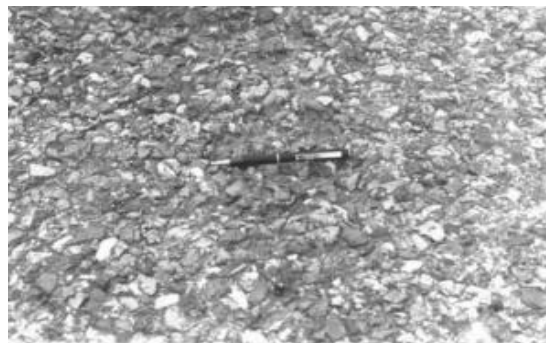
Figura 8.- Desprendimiento de Agregados
