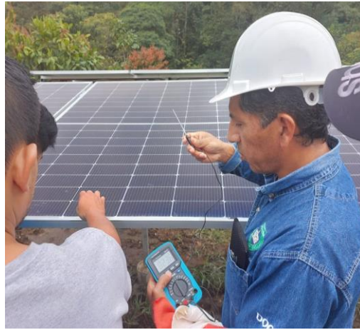
Figura 4-4: Medición de la temperatura del panel solar FV.
