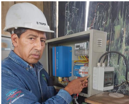
Figura 4-11: Verificación del paso de energía a través del breaker.
