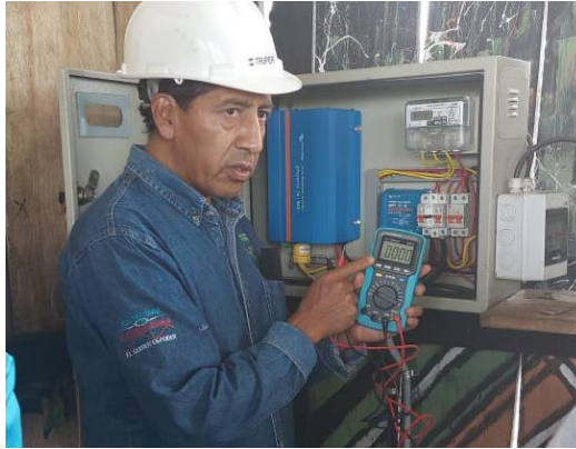
Figura 4-8: Revisión de valores de tensión DC/AC (V).
