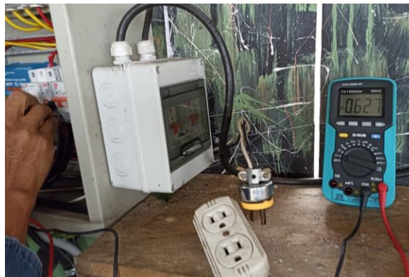
Figura 4-20: Medición de voltaje a la salida (Voc) del panel FV cada hora.
