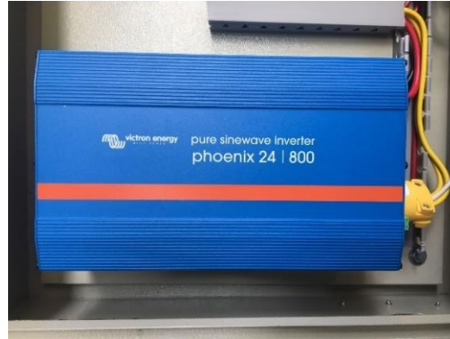
Figura 3-12: Inversor del sistema solar FV de la fundación SKIS.
