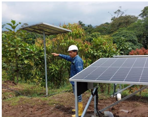
Figura 4-2: Panel FV libre de impedimento de radiación solar.
