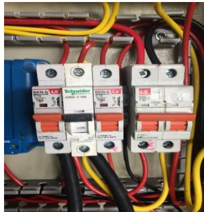
Figura 3-13: Elementos de protección del sistema fotovoltaico.
