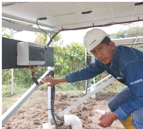
Figura 4-3: Inspección de las conexiones eléctricas del sistema FV.
