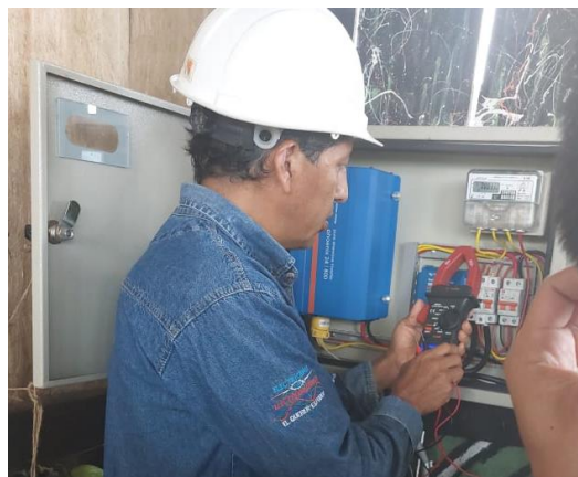
Figura 4-9: Medición de carga con una pinza amperimétrica (A).
