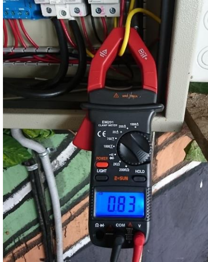
Figura 4-16: Medición de carga con el amperímetro (A).
