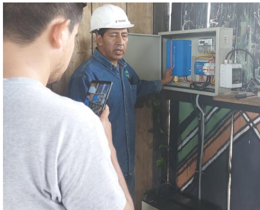
Figura 4-10: Revisión del funcionamiento adecuado del inversor de corriente.
