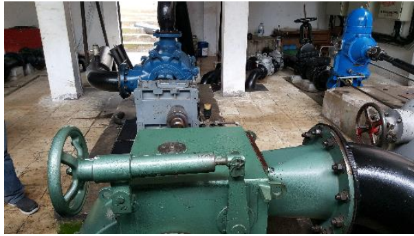
Figura 14 Sistema de bombeo [57].
