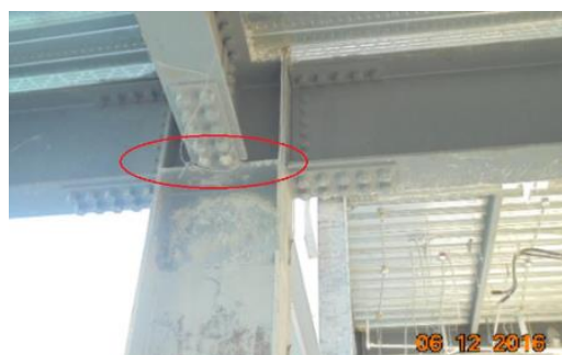
Figura 2.13. Conexión BFP en la estructura del UVC en Manta, detalle de la viga sin llegar al nudo [24]
