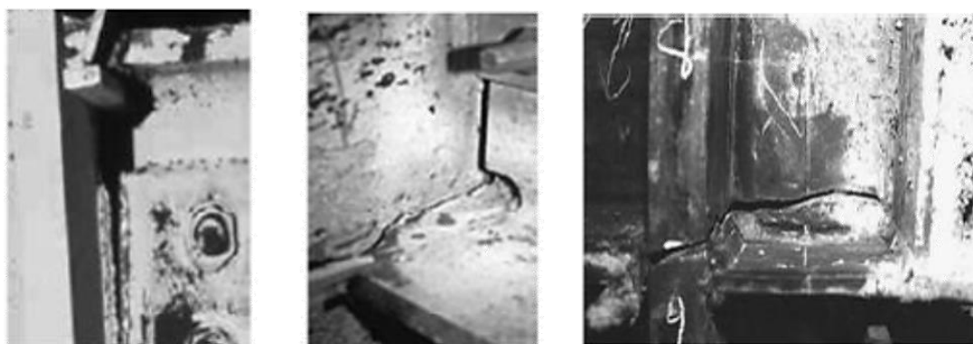
Figura 2.1. Fallas en la conexión viga-columna a causa del sismo de Northridge [12].
