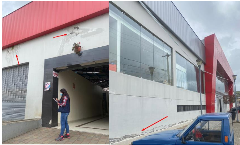
Figura 4- 10: Afectación de humedad en la mampostería de relleno
