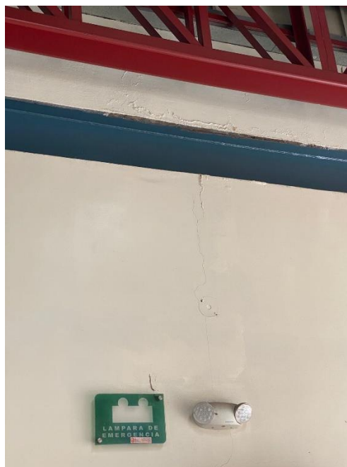
Figura 4- 11: Fisuras en la mampostería de relleno
