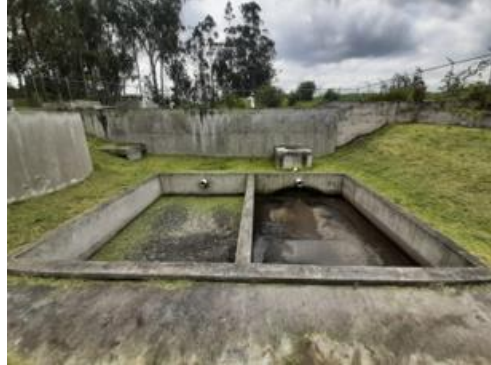
Figura 23 Lecho de secado de lodos
