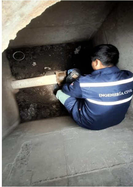
Figura 52 Apertura de válvula al lecho de secado de lodos
