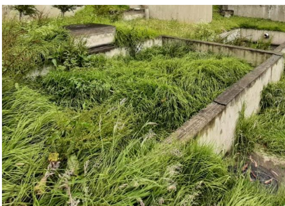
Figura 49 Presencia de vegetación en el lecho filtrante
