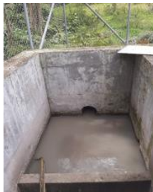
Figura 10 Pozo recolector de caudales
