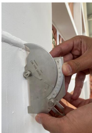
Figura 4- 65: Sobremonta excesiva en el empalme de columnas
