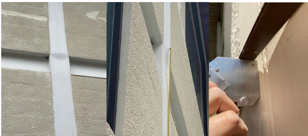
Figura 4- 14: Pandeo local en las columnas
