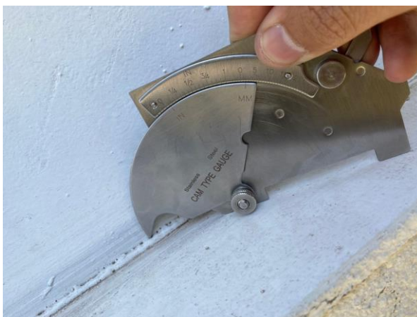
Figura 4- 63: Poros en el borde del cordón de soldadura
