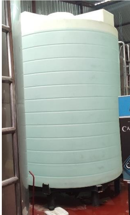
Figura - 6- Tanque de Almacenamiento de Agua - Fábrica Licoval S.A.S
