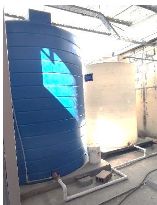
Figura - 5- Tanque de Almacenamiento de Alcohol - Fábrica Licoval S.A.S
