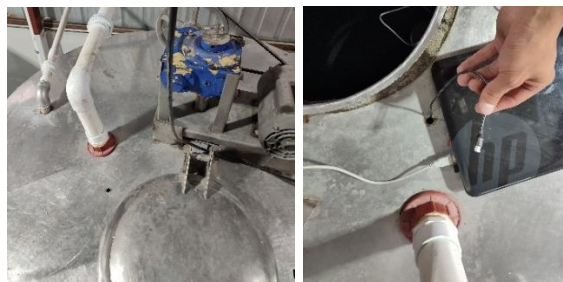
Figura - 66- Orificio para la colocación del sensor Ultrasónico - Tanque de 5000 Litros
