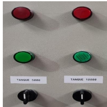
Figura - 11- Accionamiento de los tanques de mezcla
