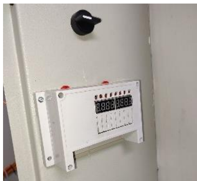
Figura - 75- HMI en nuestro tablero de control
