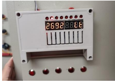
Figura - 78- Cantidad de litros en el tanque de 10000 L
