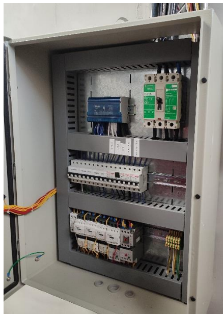
Figura - 25- Conexiones Internas del panel de control
