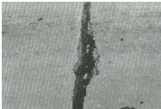
Gráfica 88 Falla sellada con un nivel de deterioro medio Fuente: L. Vásquez, Pavement Condition Index (PCI) para pavimentos asfálticos y de concreto en carreteras-2002
