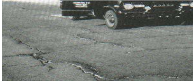
Gráfica 17 Agrietamiento en bloque nivel de deterioro alto Fuente: L. Vásquez, Pavement Condition Index (PCI) para pavimentos asfálticos y de concreto en carreteras-2002
