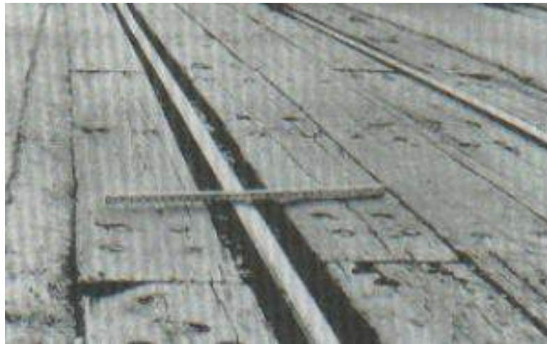
Gráfica 56 Cruce de vía férrea con un nivel de deterioro medio Fuente: L. Vásquez, Pavement Condition Index (PCI) para pavimentos asfálticos y de concreto en carreteras-2002
