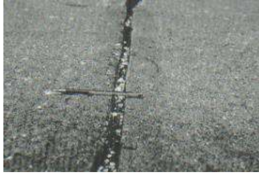
Gráfica 89 Falla sellada con un nivel de deterioro alto
