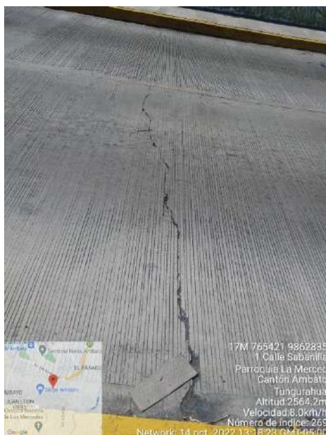
Gráfica 174 Daño representativo tipo Agrietamiento Transversal Fuente: Daniela Leyton (2023)
