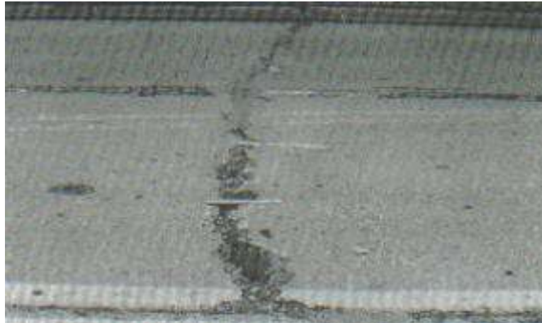
Gráfica 78 Grietas con un nivel de deterioro alto de una losa de concreto simple Fuente: L. Vásquez, Pavement Condition Index (PCI) para pavimentos asfálticos y de concreto en carreteras-2002
