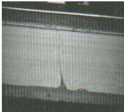
Gráfica 43 Grietas longitudinales y transversales con un nivel de deterioro bajo Fuente: L. Vásquez, Pavement Condition Index (PCI) para pavimentos asfálticos y de concreto en carreteras-2002
