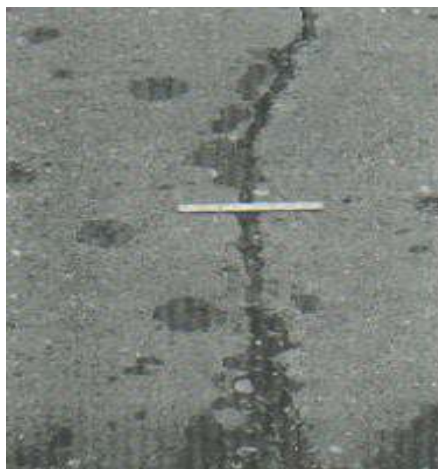
Gráfica 77 Grietas con un nivel de deterioro medio de una losa de concreto reforzado Fuente: L. Vásquez, Pavement Condition Index (PCI) para pavimentos asfálticos y de concreto en carreteras-2002
