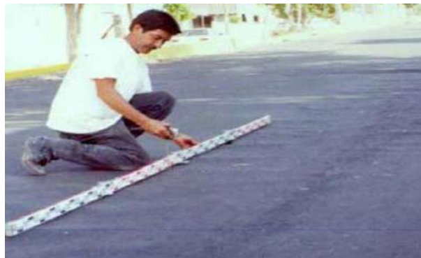
Gráfica 22 Corrugaciones en la carretera Fuente: Manual de Evaluación de Pavimentos-2004
