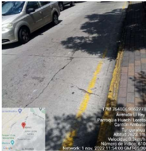
Gráfica 177 Daño representativo tipo Agrietamiento Longitudinal Fuente: Daniela Leyton (2023)
