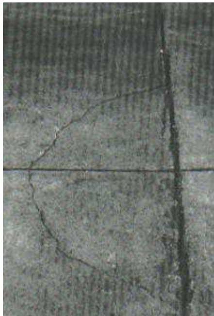
Gráfica 83 Grieta de esquina nivel de deterioro bajo Fuente: L. Vásquez, Pavement Condition Index (PCI) para pavimentos asfálticos y de concreto en carreteras-2002
