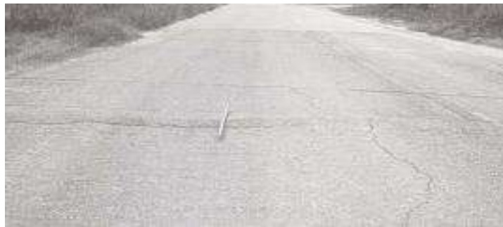
Gráfica 70 Hinchamiento con un nivel de deterioro medio Fuente: Manual de Pavimentos
