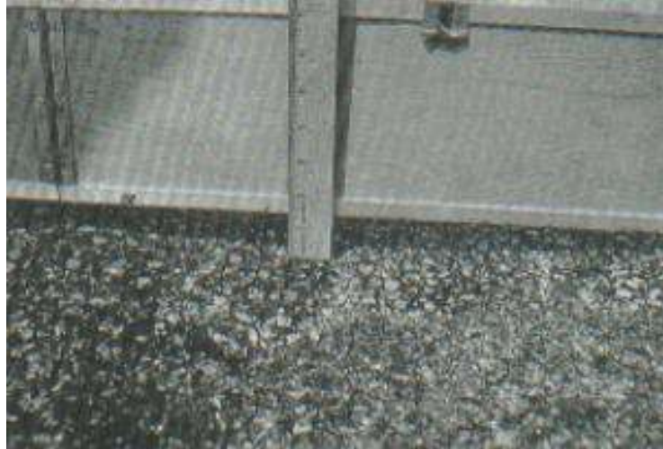
Gráfica 61 Ahuellamiento con un nivel de deterioro alto Fuente: L. Vásquez, Pavement Condition Index (PCI) para pavimentos asfálticos y de concreto en carreteras-2002
