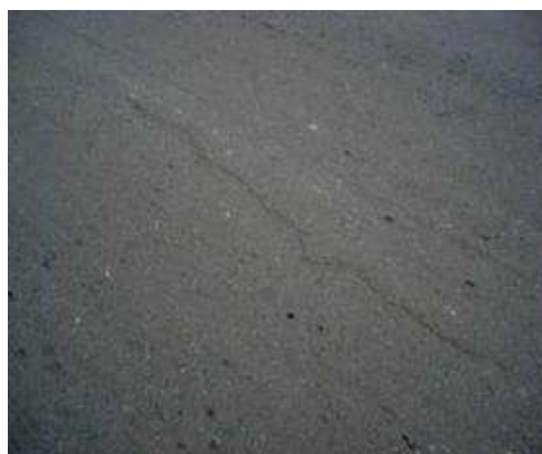
Gráfica 42 Grietas longitudinales y transversales en la carretera
