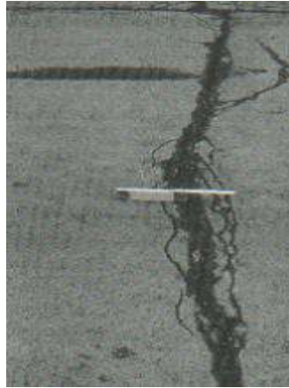
Gráfica 37 Grieta de reflexión de junta nivel de deterioro alto Fuente: L. Vásquez, Pavement Condition Index (PCI) para pavimentos asfálticos y de concreto en carreteras-2002
