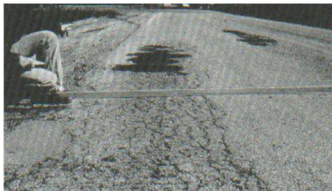
Gráfica 9 Piel de cocodrilo nivel de deterioro alto
