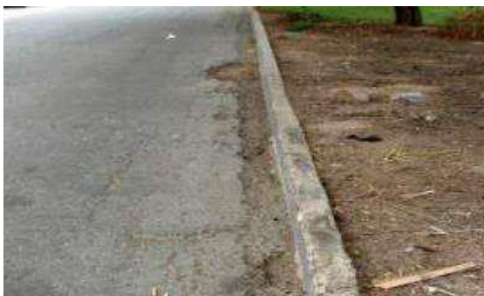
Gráfica 30 Agrietamiento de borde en carretera Fuente: Identificación y Evaluación de las fallas superficiales en los pavimentos flexibles de algunas vías de la ciudad de Barranca – 2017.
