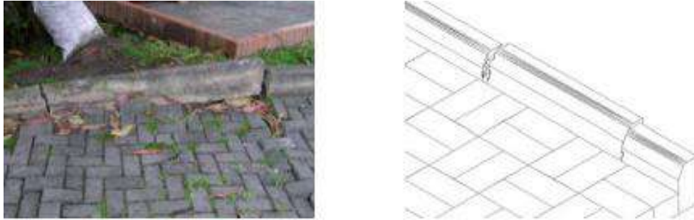
Gráfica 98 Fracturamiento de confinamientos externos Fuente: C. Higuera. y O. Pacheco, Patología de pavimentos articulados-2010
