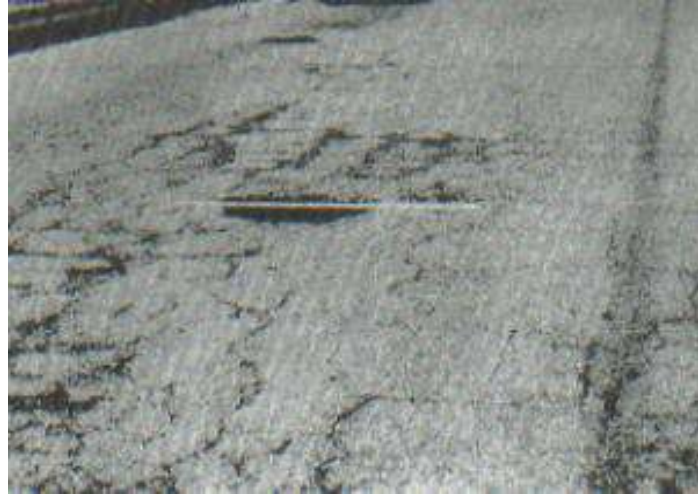
Gráfica 53 Hueco con nivel de deterioro medio
