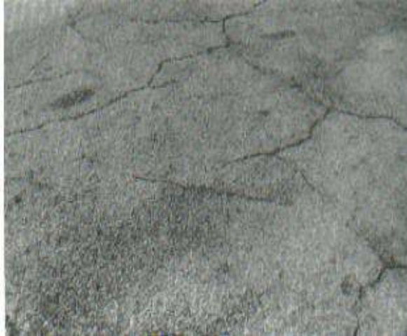
Gráfica 15 Agrietamiento en bloque nivel de deterioro bajo Fuente: L. Vásquez, Pavement Condition Index (PCI) para pavimentos asfálticos y de concreto en carreteras-2002
