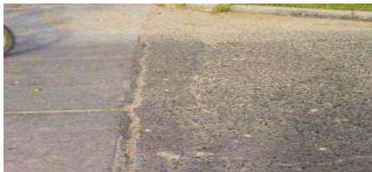
Gráfica 62 Desplazamiento en la carretera Fuente: Identificación y Evaluación de las fallas superficiales en los pavimentos flexibles de algunas vías de la ciudad de Barranca – 2017. Nivel de deterioro:
