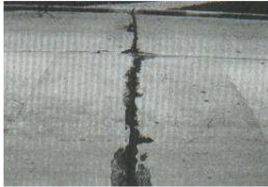
Gráfica 87 Falla sellada con un nivel de deterioro bajo Fuente: L. Vásquez, Pavement Condition Index (PCI) para pavimentos asfálticos y de concreto en carreteras-2002
