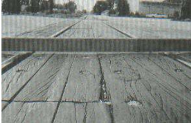
Gráfica 55 Cruce de vía férrea con un nivel de deterioro bajo Fuente: L. Vásquez, Pavement Condition Index (PCI) para pavimentos asfálticos y de concreto en carreteras-2002
