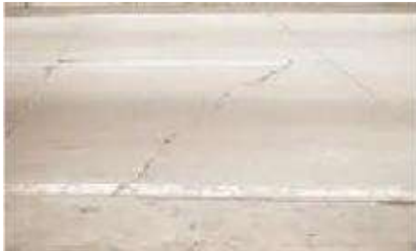
Gráfica 74 Agrietamiento Transversal en la carretera Fuente: R. Ricardo, Deterioros en pavimentos flexibles y rígidos-2010
