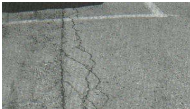
Gráfica 32 Grieta de Borde nivel de deterioro medio
