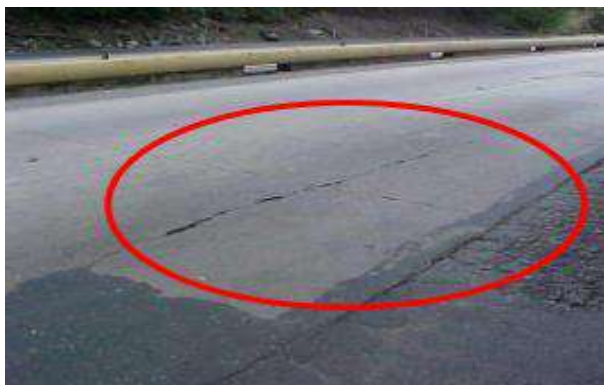
Gráfica 80 Agrietamiento Longitudinal en la carretera Fuente: José Heredia & Asociados C.A, Clasificación de las fallas de pavimento flexibles y rígidos-2018
