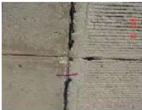
Gráfica 86 Falla en el sellado de la Junta
