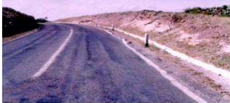
Gráfica 69 Hinchamiento en la carretera Fuente: Manual de Pavimentos
