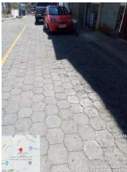
Gráfica 183 Daño representativo tipo Ahuellamiento Fuente: Daniela Leyton (2023)
