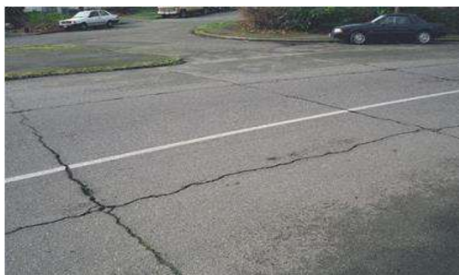
Gráfica 34 Grieta de reflexión de junta en la carretera
