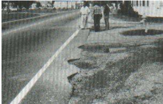
Gráfica 33 Grieta de Borde nivel de deterioro alto
