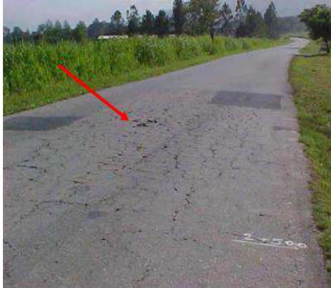
Gráfica 6 falla piel de cocodrilo José Heredia & Asociados C.A. Clasificación de las fallas de pavimento flexibles y rígidos-2018
