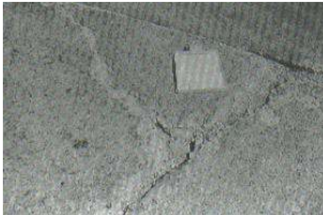
Gráfica 85 Grieta de esquina nivel de deterioro alto Fuente: L. Vásquez, Pavement Condition Index (PCI) para pavimentos asfálticos y de concreto en carreteras-2002
