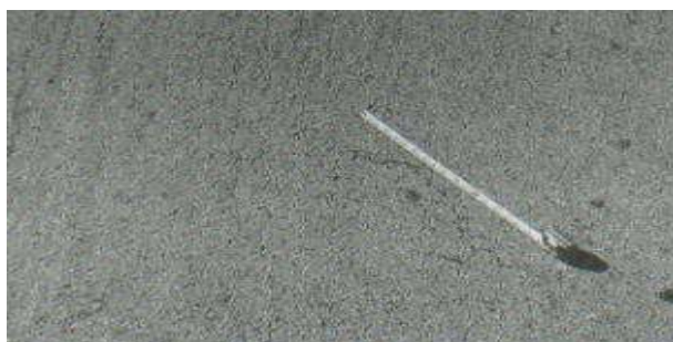
Gráfica 66 Grieta Parabólica con un nivel de deterioro bajo Fuente: L. Vásquez, Pavement Condition Index (PCI) para pavimentos asfálticos y de concreto en carreteras-2002
