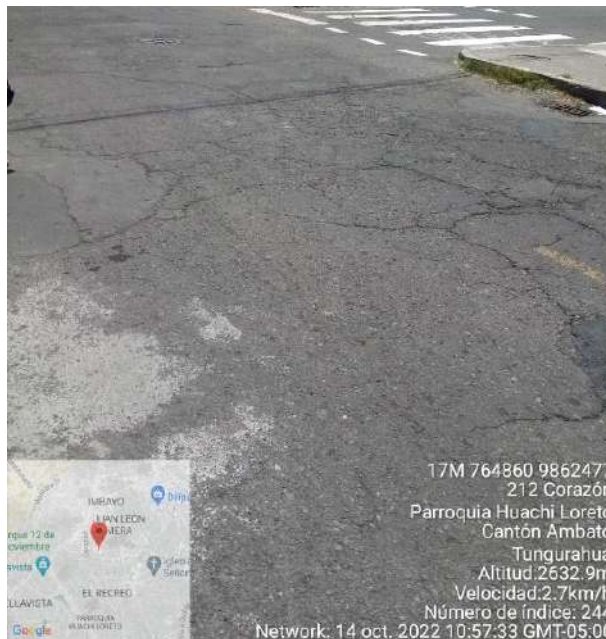
Gráfica 153 Daño representativo tipo Agrietamiento en Bloque Fuente: Daniela Leyton (2023)
