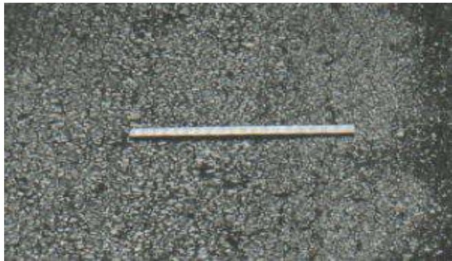
Gráfica 71 Desprendimiento de agregados con un nivel de deterioro bajo Fuente: L. Vásquez, Pavement Condition Index (PCI) para pavimentos asfálticos y de concreto en carreteras-2002
