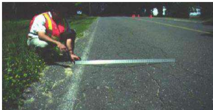
Gráfica 26 Depresión o Hundimiento en la carretera
