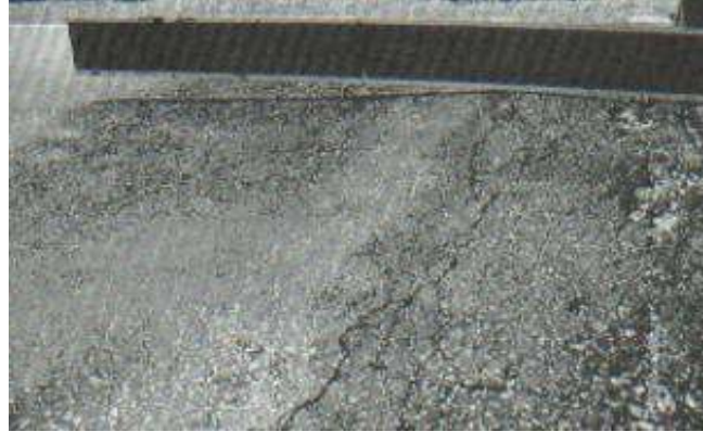
Gráfica 21 Abultamiento o hundimiento nivel de deterioro alto Fuente: L. Vásquez, Pavement Condition Index (PCI) para pavimentos asfálticos y de concreto en carreteras-2002
