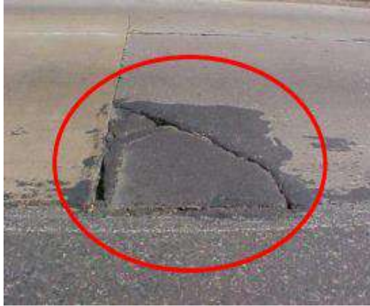
Gráfica 82 Grieta de esquina en la carretera Fuente: José Heredia & Asociados C.A, Clasificación de las fallas de pavimento flexibles y rígidos-2018
