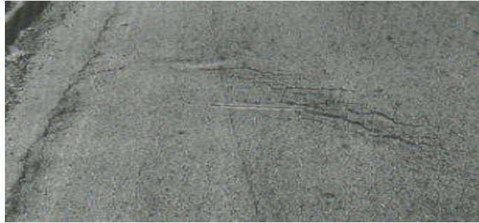
Gráfica 67 Grieta Parabólica con un nivel de deterioro medio Fuente: L. Vásquez, Pavement Condition Index (PCI) para pavimentos asfálticos y de concreto en carreteras-2002
