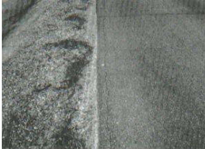
Gráfica 31 Grieta de Borde nivel de deterioro bajo
