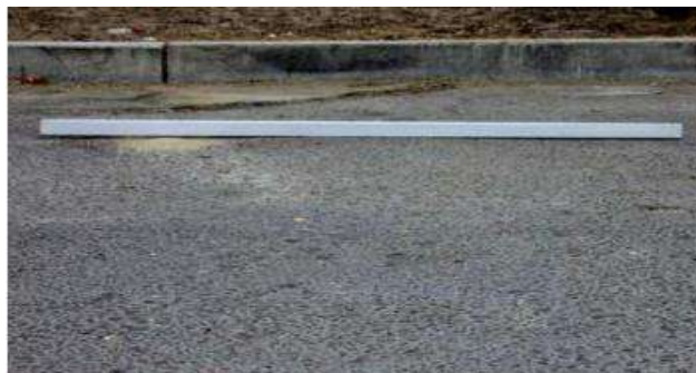
Gráfica 18 Vista de abultamientos y hundimientos en la carretera Fuente: Identificación y Evaluación de las fallas superficiales en los pavimentos flexibles de algunas vías de la ciudad de Barranca – 2017.
