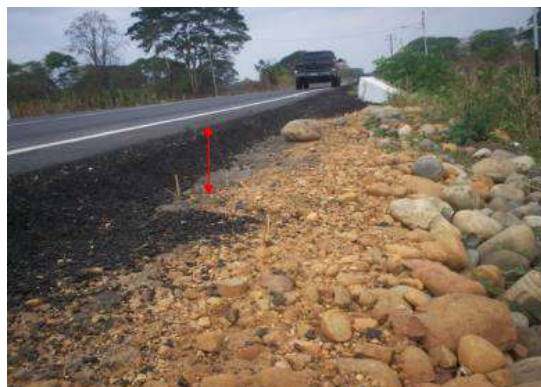
Gráfica 38 Desnivel carril/ berma en la carretera Fuente: Manual de Evaluación de Pavimentos-2004
