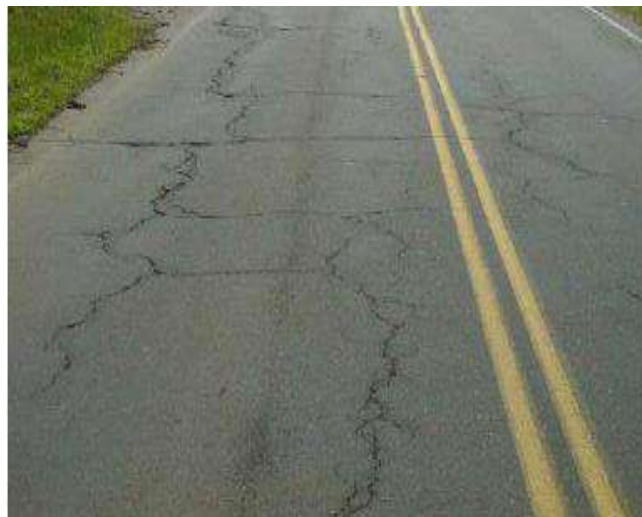
Gráfica 14 Vista de Agrietamiento en bloque en la carretera Fuente: Identificación y Evaluación de las fallas superficiales en los pavimentos flexibles de algunas vías de la ciudad de Barranca – 2017.
