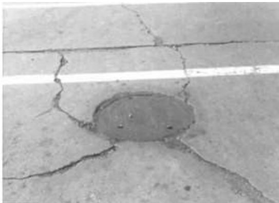
Gráfica 28. Fisura inducida (Estructura Fija).
