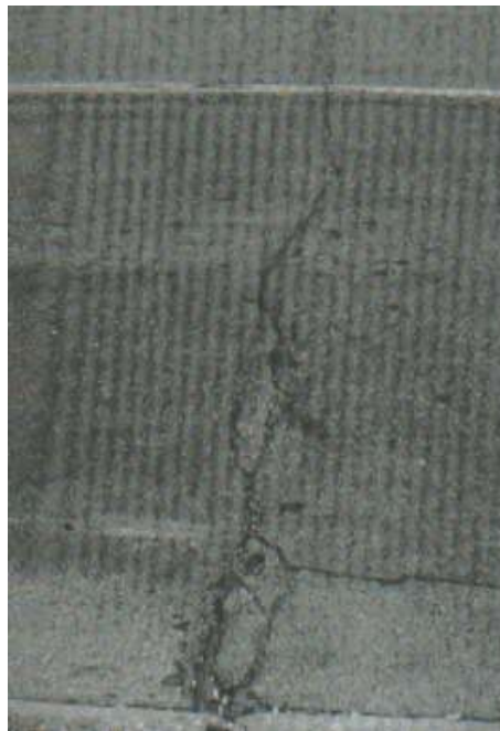
Gráfica 15. Grietas de reflexión de junta.
