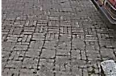
Gráfica 40. Desplazamiento de juntas en pavimento articulado.
