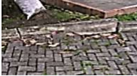
Gráfica 42. Fracturamiento de confinamientos externos en pavimento articulado.
