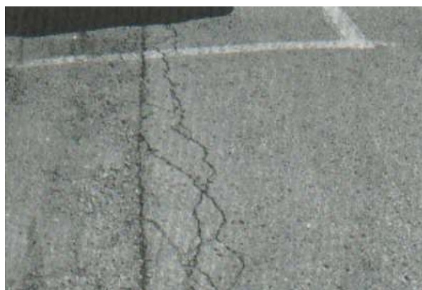
Gráfica 14. Grietas en borde.
