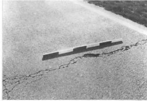
Gráfica 7. Fisura transversal severa.
