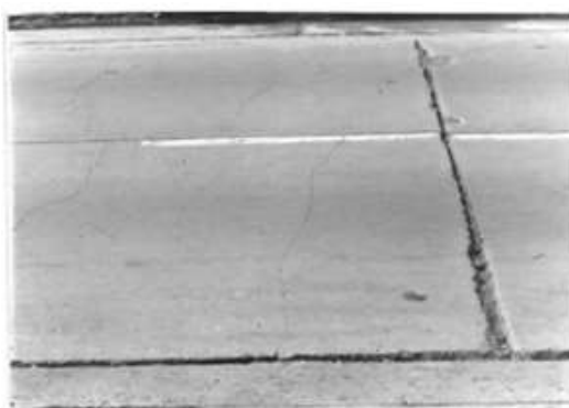
Gráfica 24. Fisura transversal severidad baja.
