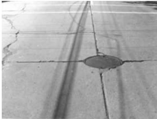
Gráfica 27. Fisura inducida (Sustituye Junta).
