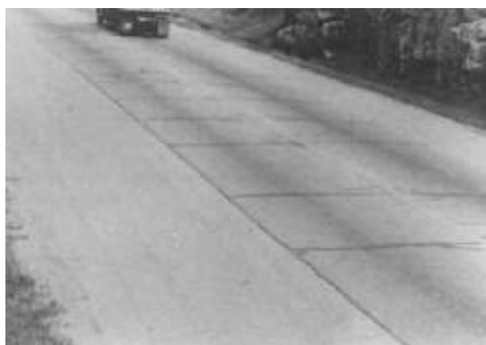
Gráfica 10. Fisuras refleja severidad baja.
