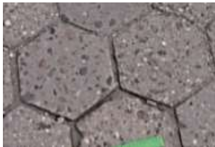
Gráfica 37. Desgaste superficial en pavimento articulado.
