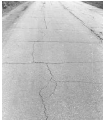
Gráfica 8. Fisura en bloques de severidad alta.
