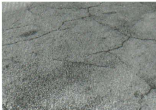
Gráfica 13. Grietas en bloque.
