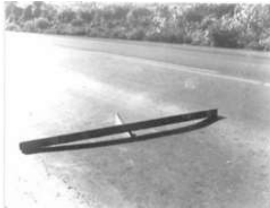
Gráfica 2. Ahuellamiento de Severidad Baja
