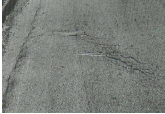
Gráfica 20. Grieta parabólica.
