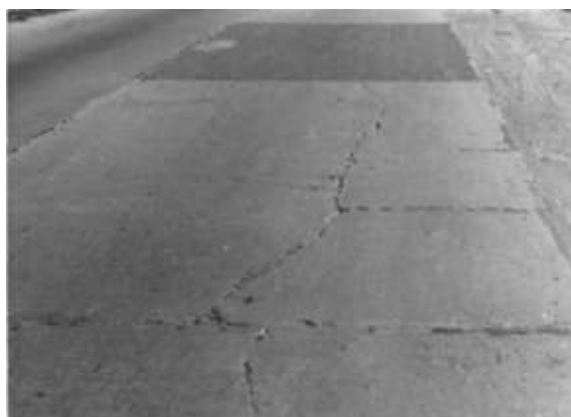
Gráfica 26. Fisura múltiple.
