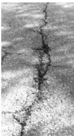
Gráfica 6. Fisura severa alta longitudinal.
