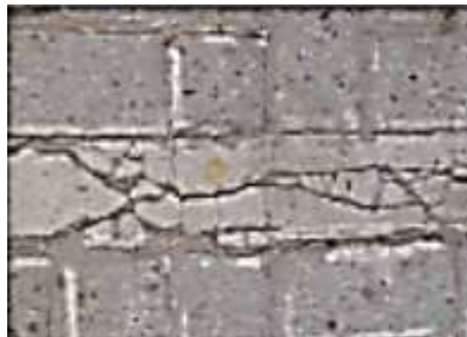
Gráfica 43. Fracturamiento de confinamientos internos en pavimento articulado.
