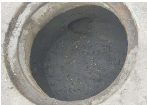
Gráfico 24 Fondos de pozos en mal estado
