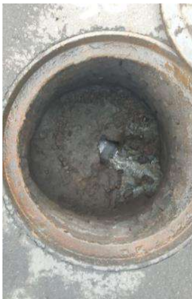
Gráfico 28 Pozos con tuberías rotas
