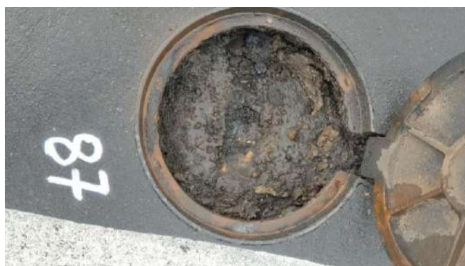
Gráfico 27 Pozos con obstrucción en la entrada
