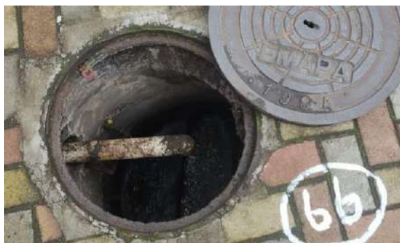
Gráfico 26 Pozos con tuberías sin revocar
