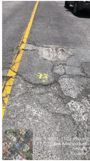
Gráfico 13: Fisuramiento – Pavimento Rígido
