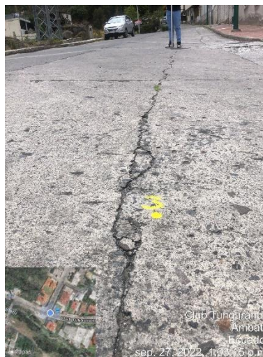
Gráfico 15: Agrietamiento longitudinal – Pavimento Rígido
