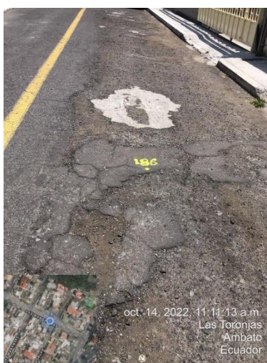
Gráfico 10: Desprendimiento de agregados – Pavimento Flexible
