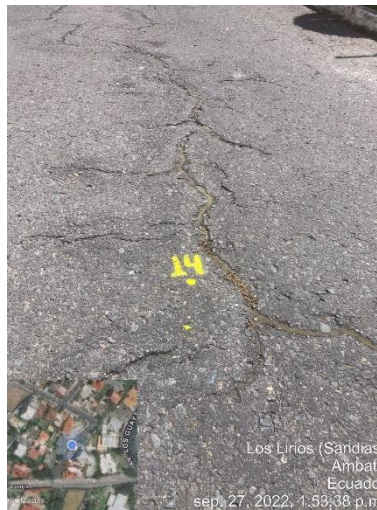
Gráfico 6: Grietas Longitudinales y transversales – Pavimento Flexible
