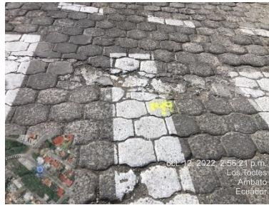
Gráfico 20: Ahuellamiento – Pavimento Articulado
