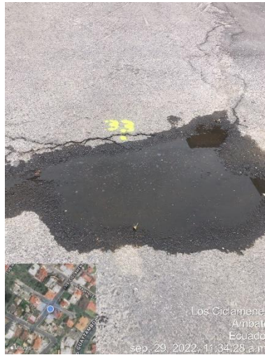
Gráfico 4: Abultamientos y Hundimientos – Pavimento Flexible
