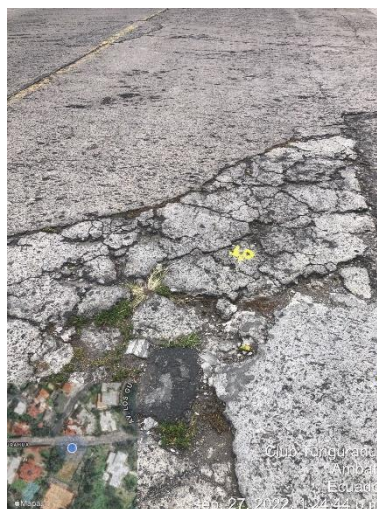
Gráfico 16: Desintegración – Pavimento Rígido
