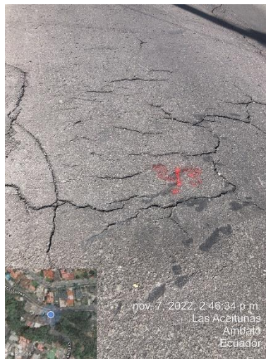
Gráfico 3: Agrietamiento en Bloque – Pavimento Flexible
