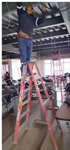
Figura 13. Uso incorrecto de la escalera en el proceso de instalación.
