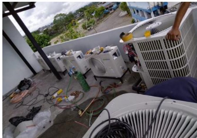
Figura 12. Desorden en instalación de equipos de aire acondicionado.
