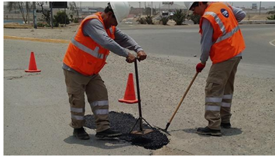
Figura 2. Puesta en bache mezcla asfáltica en frío compuesta por agregados y un ligante asfáltico
