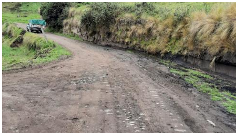
Ilustración 11. Estado actual de la vía en Tuglín
