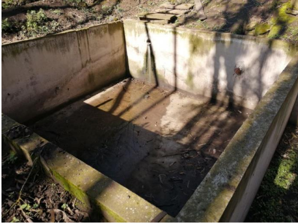
Figura 51. Lecho de secado de lodos de la P.T.A.R actual.
