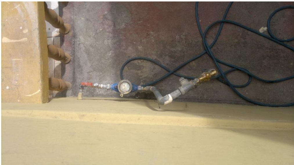
Medidor mal ubicado
