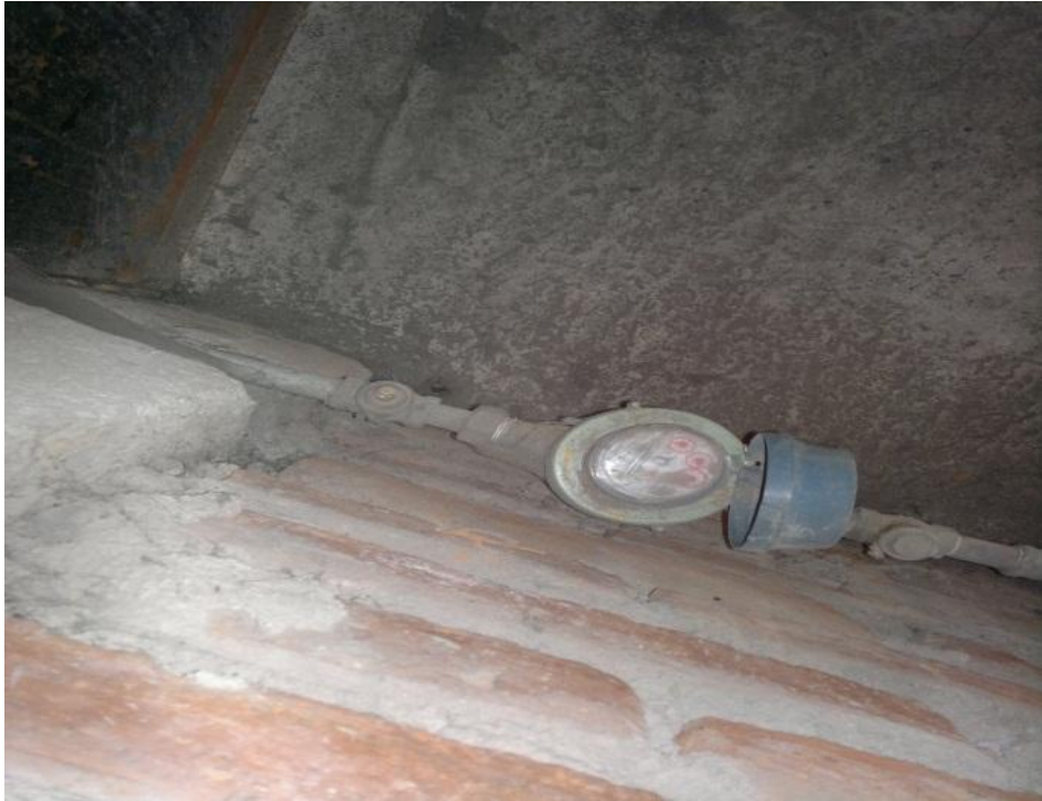
Medidor sucio o ilegible
