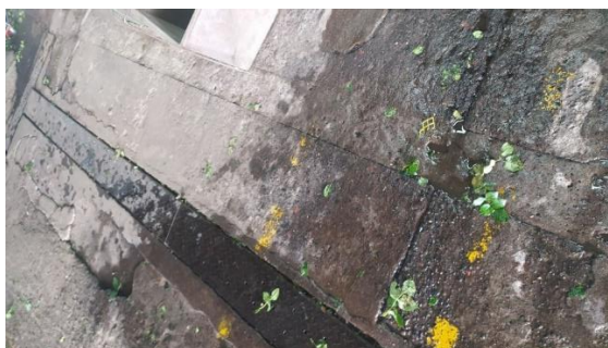
Figura 43: Problemas en el piso de la zona de recepción
