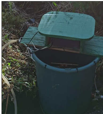
Figura 91: Llenado del tanque modo automático.
