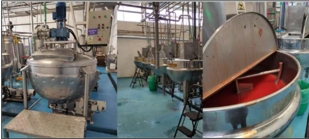
Fotografía 2.3: Homogeneizadora y marmitas eléctricas.
