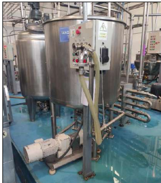
Fotografía 2.5: Tanque de almacenamiento Cap. 2000 litros.
