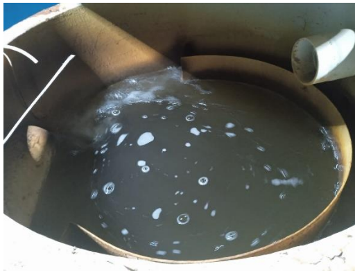
Imagen 20. Funcionamiento del tanque decantador
