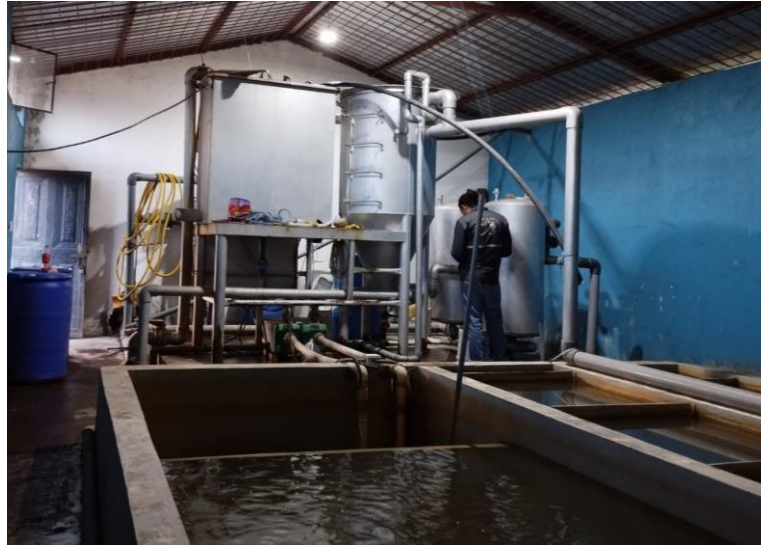
Imagen 11. Planta de tratamiento de agua potable
