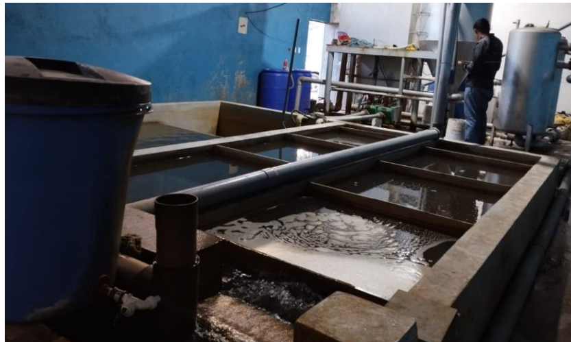
Imagen 12. Tanque floculador y sedimentador
