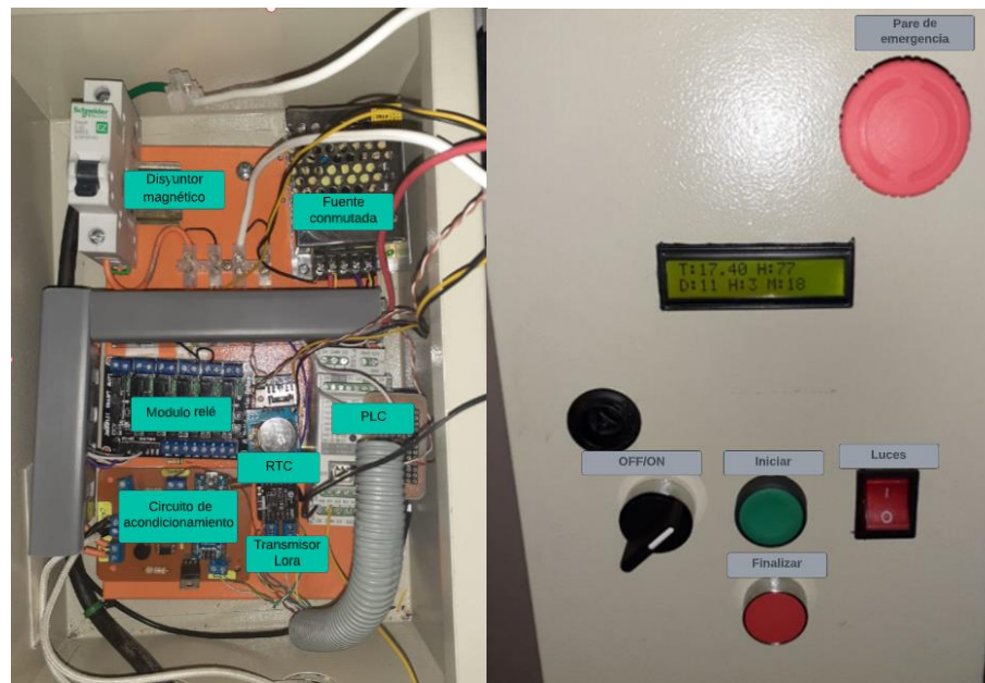
Figura 61.- Tablero de control
