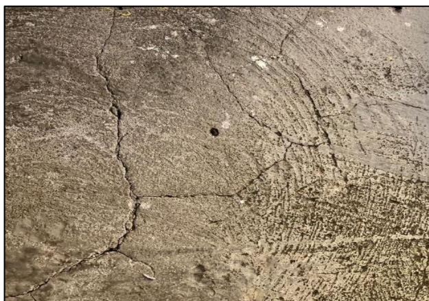
Figura 55. Fisura por retracción plástica.
