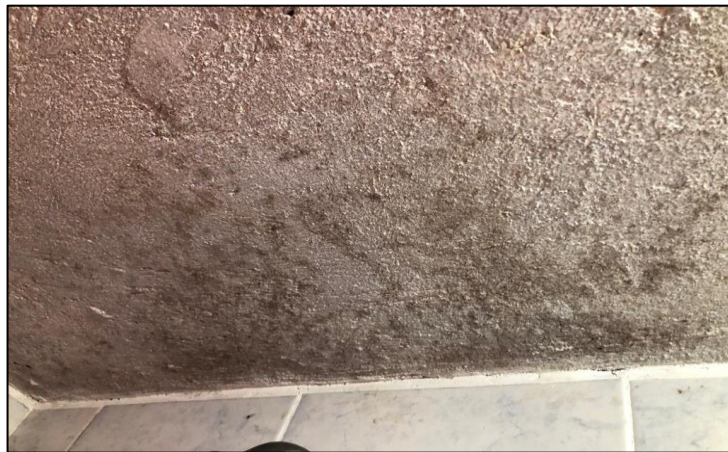
Figura 32. Humedad de condensación.
