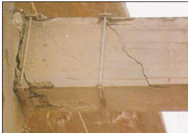
Figura 51. Grietas por torsión.
