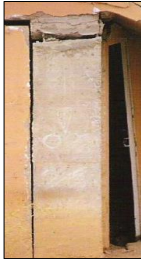
Figura 45. Grietas por tracción.
