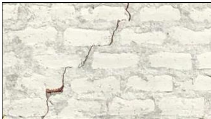
Figura 37. Grieta entre el mampuesto y el mortero.
