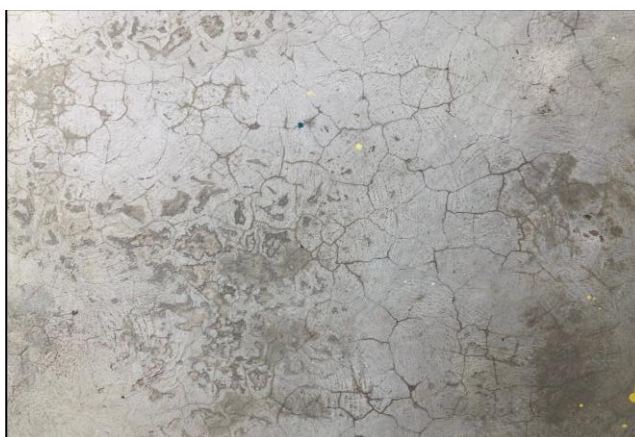
Figura 53. Fisura por retracción hidráulica.
