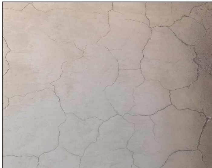
Figura 24. Fisura de piel de cocodrilo en enlucidos.
