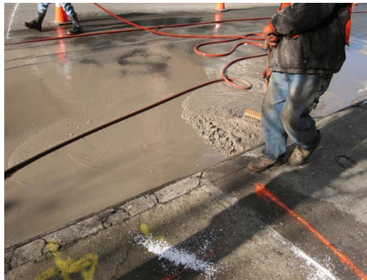
Figura 1. Humedad de obra.
