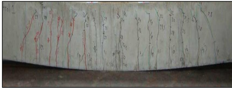
Figura 49. Grietas por flexión.
