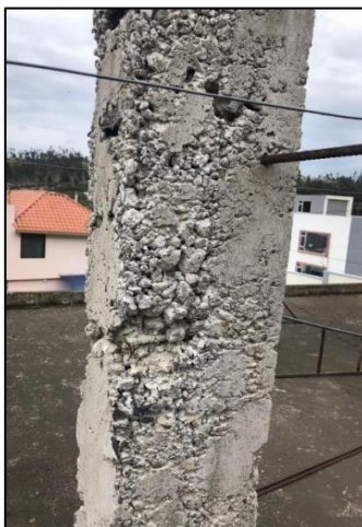
Figura 73. Coqueras por disgregación.
