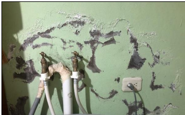
Figura 19. Humedad accidental cara interna.
