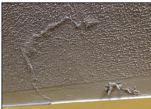
Figura 28. Humedad por filtración cara interna.
