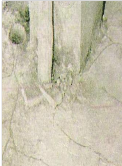
Figura 57. Fisura por punzonamiento.
