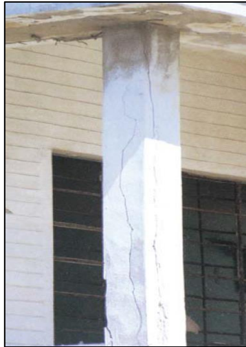
Figura 43. Grietas por compresión.
