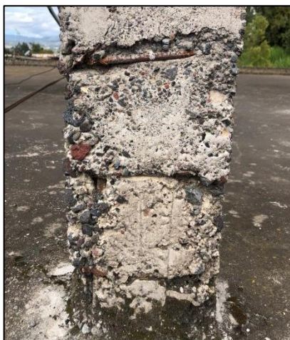
Figura 71. Corrosión en la armadura.
