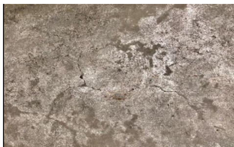
Figura 29. Humedad por filtración cara externa.
