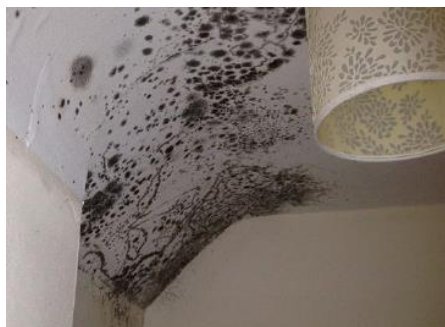
Figura 4. Humedad de condensación.
