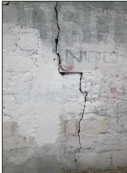
Figura 39. Grieta que rompe el mampuesto.
