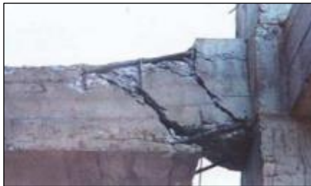
Figura 47. Grietas por cortante.
