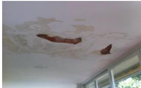
Figura3. Humedad por filtración.
