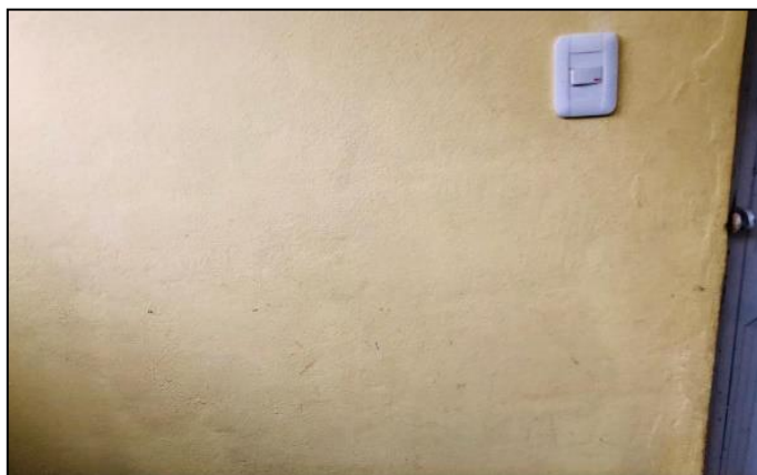
Figura 20. Humedad accidental cara externa.
