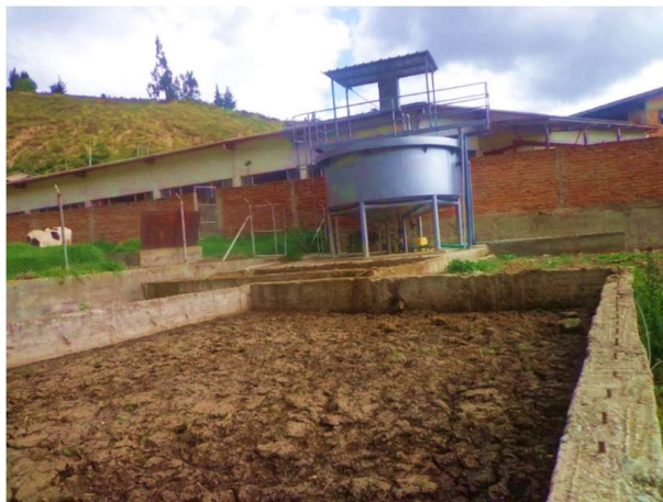
Figura 18: Planta de tratamiento de aguas residuales del camal municipal
