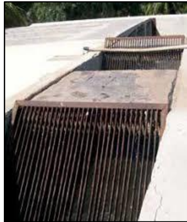
Figura 15: Cribado (Reja metálica)
