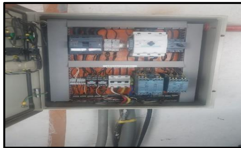
Figura 36: Caja de Revisión Eléctrica
