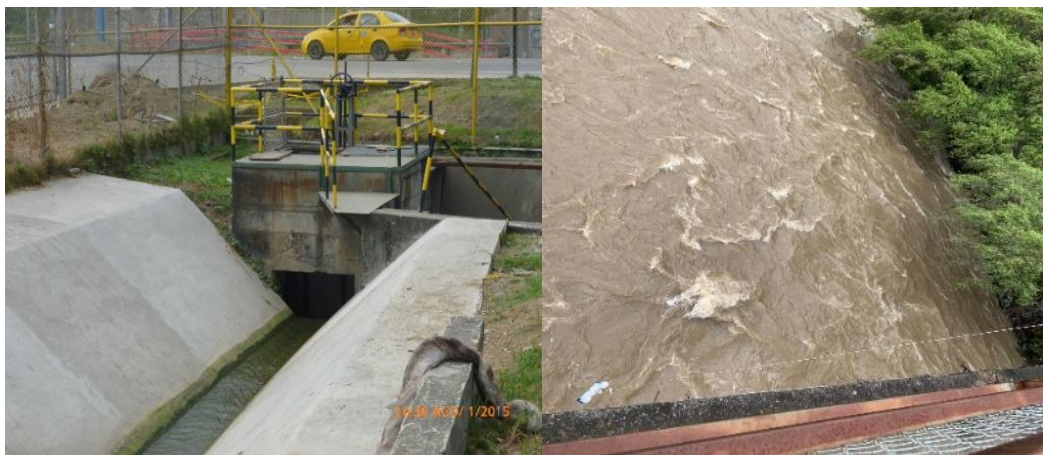
Figura 3. Descarga de la Refinería de Esmeraldas y Punto 1 de muestreo
