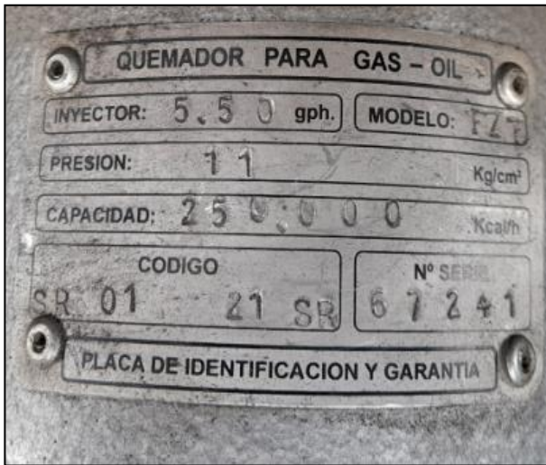
Figura 35: Placa de identificación del quemador automático.
