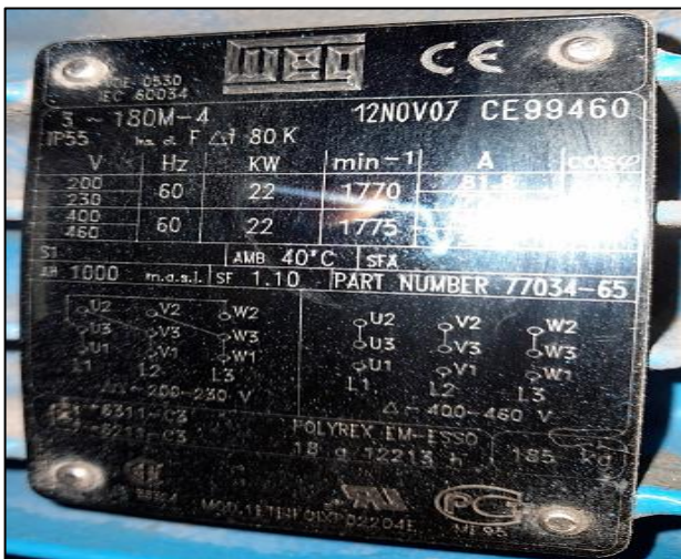
Figura 33: Placa de identificación, motor del compresor de aire.
