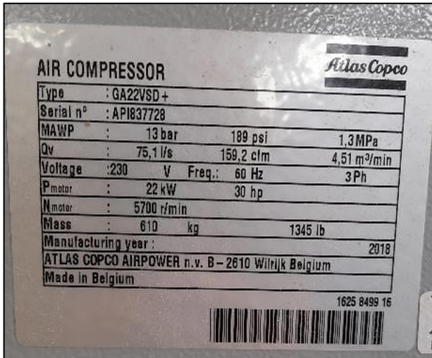
Figura 31: Placa de identificación del compresor de tornillo rotativo.
