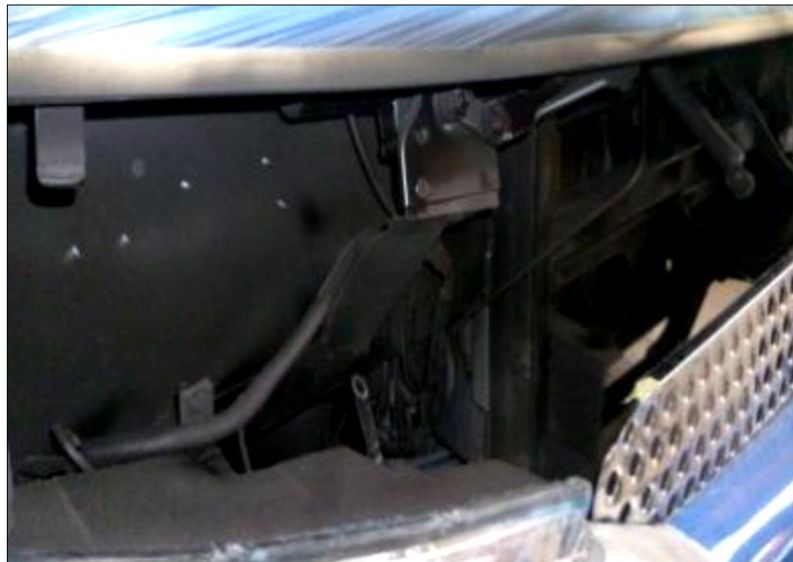
Figura 17: Calafateo en el interior de la mascarilla.
