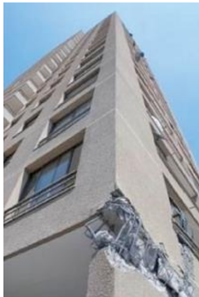
Figura 4: Falla por insuficiente confinamiento en una estructura
