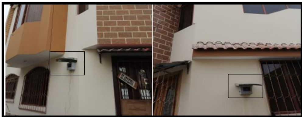
Figura 73: Nodos finales instalados en las viviendas.
