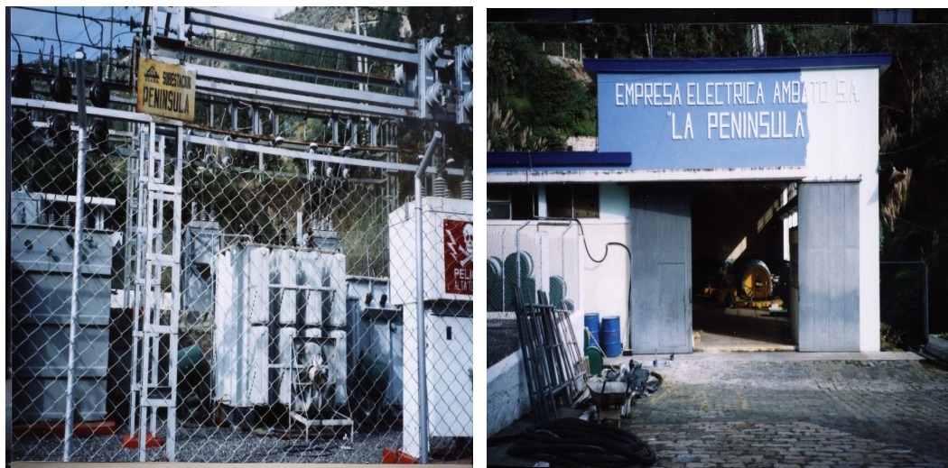
Figura 7.- Central hidráulica La Península
